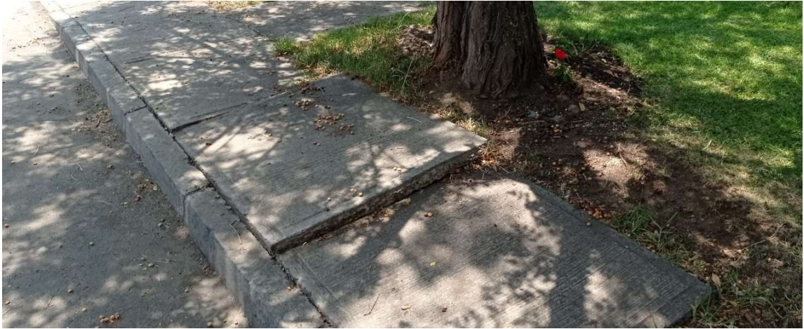
Figura 44: Obstáculos registrados – Rotura de Pavimento 2
