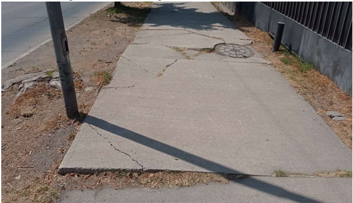
Figura 43: Obstáculos registrados – Rotura de Pavimento 1
