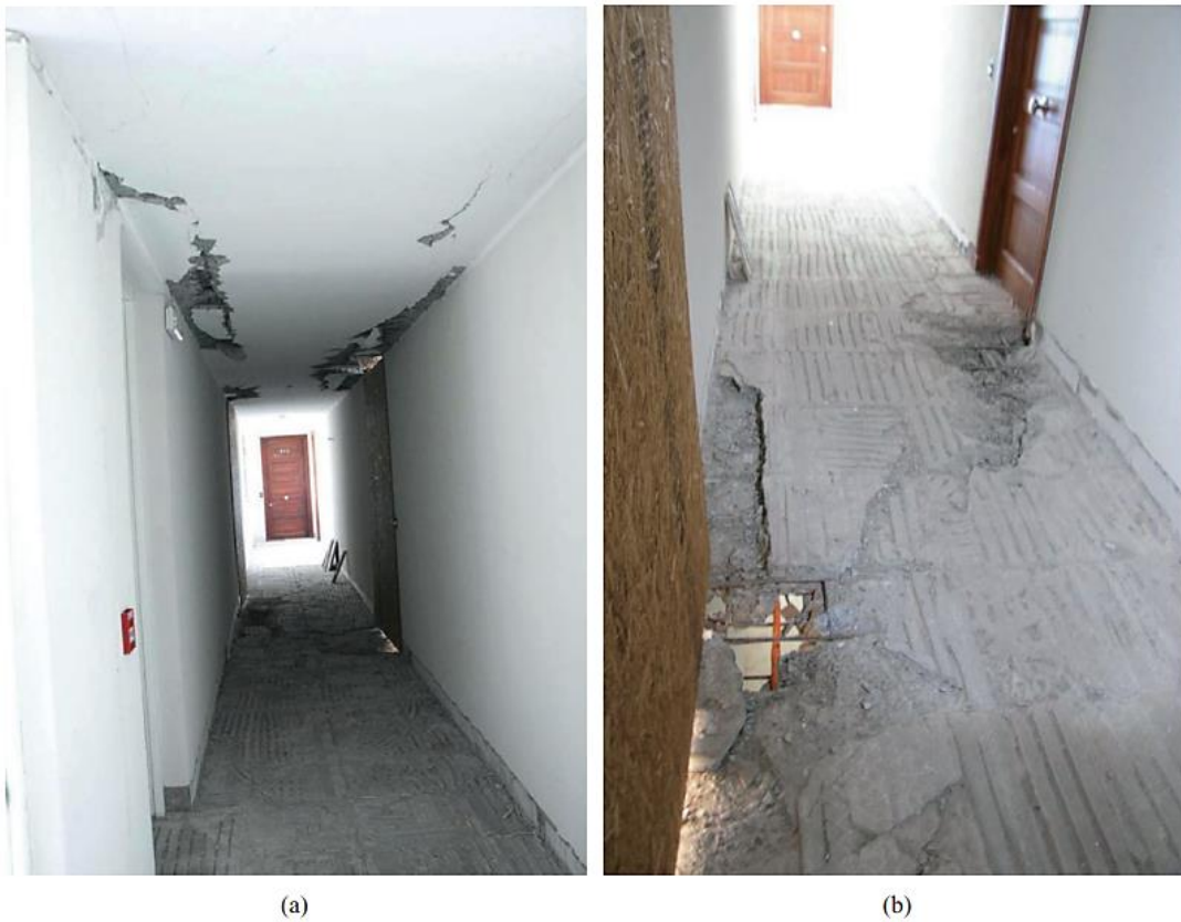
Figura 2.21. Daño en losas de acoplamiento. Edificio Bosquemar , Concepción.
