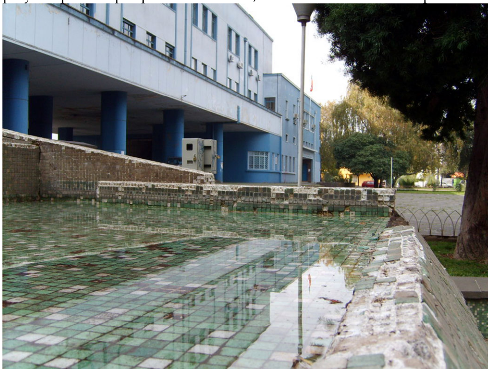
Fig. 8: Estado actual de la pileta del Edificio de los Servicios Públicos de Chillán, Chile.
