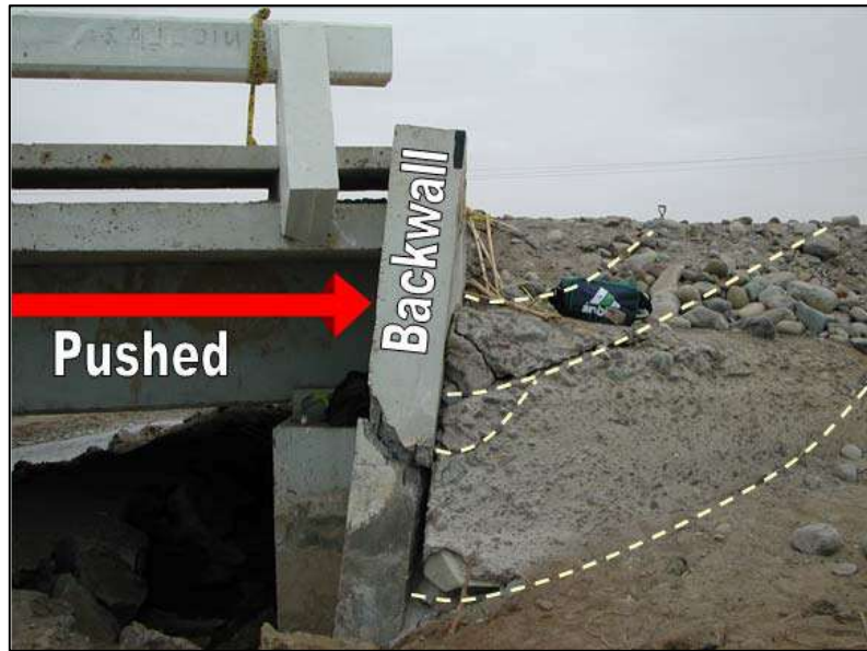
Figura 5: Falla por corte en muro espaldar y movilización de la cuña pasiva. (Shamsabadi 2007)
