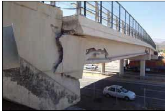
Figura 1: Falla en la llave de corte del estribo del puente de Chada.(Transportation 2011)
