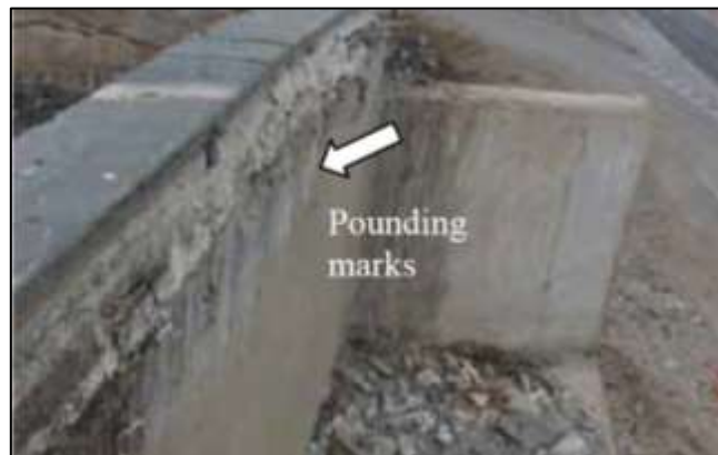
Figura 4: Marcas de golpeteo en estribo oeste, del puente Romero, Chile.(Transportation 2011)
