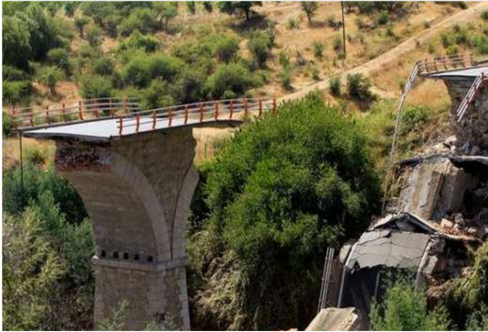
Figura 11.22: Terremoto del Maule, Cauquenes 2010, derrumbe puente, (Ortiz, 2012)
