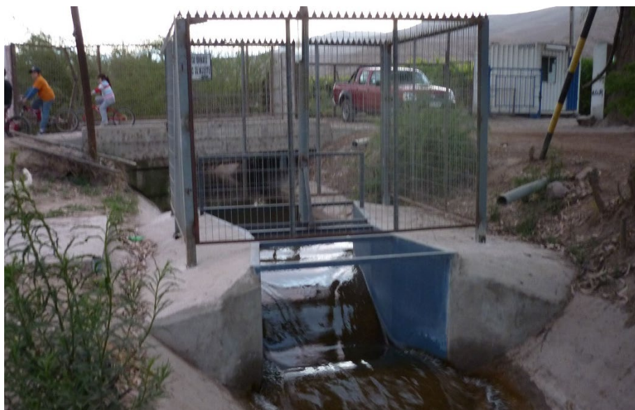
Figura 3.2: Aforador satelital al inicio del canal, Km 0+286
