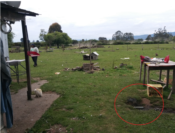
Figura 3.1: Zona de descarga de lavaplatos. Encerrado en rojo zona en que cañería descarga los efluentes.
