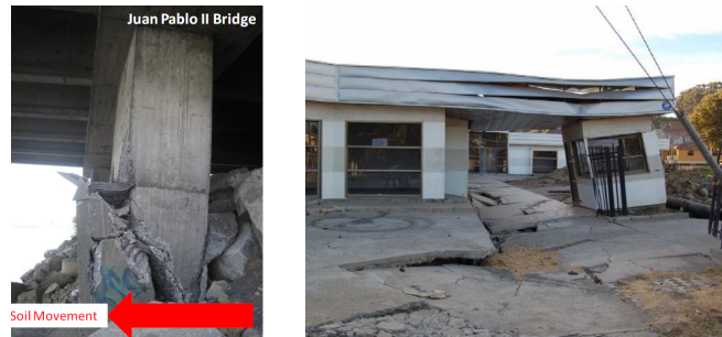
(a) Falla columna puente Juan Pablo II. (Ledezma, 2013). (b) Desplazamiento lateral observado en Constitución, Región del Maule, (González, 2015).
