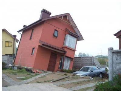
(a) Asentamiento del terreno. (Ledezma, 2013).
