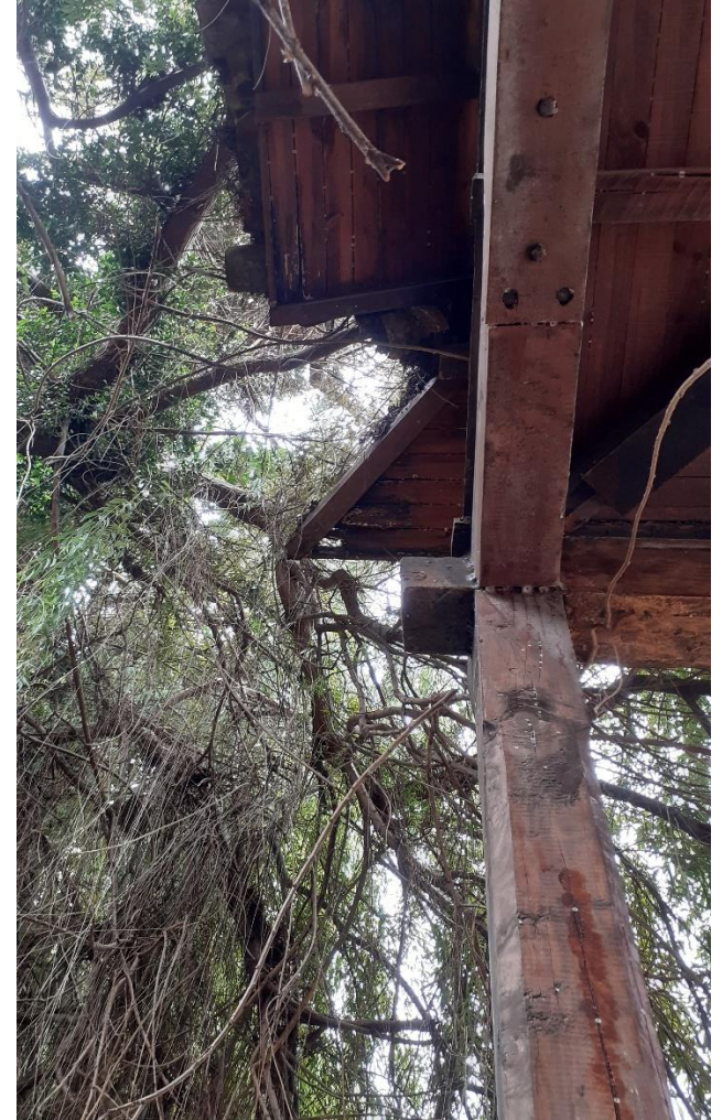
Figura 17: Elaboración propia Foto esquina Suroriente en deterioro.
