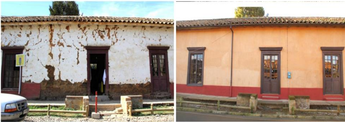
Imágenes 75 y 76: Vivienda en Vichuquén con Subsidio de reconstrucción patrimonial. Fuente: CMN 2021.
