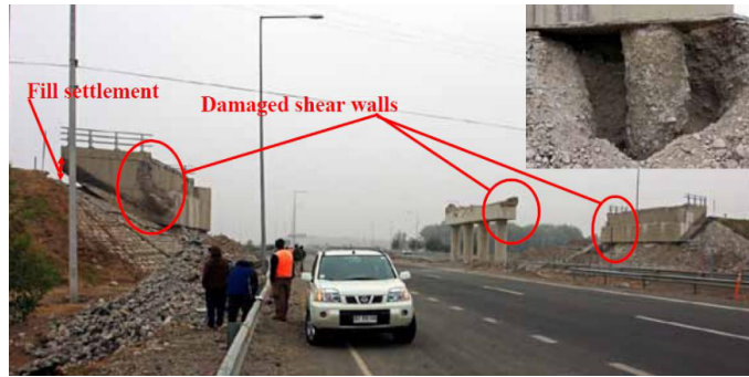
Figura 3.9.1: Daños en Paso Inferior Los Pinos. Fuente: González (2015).
