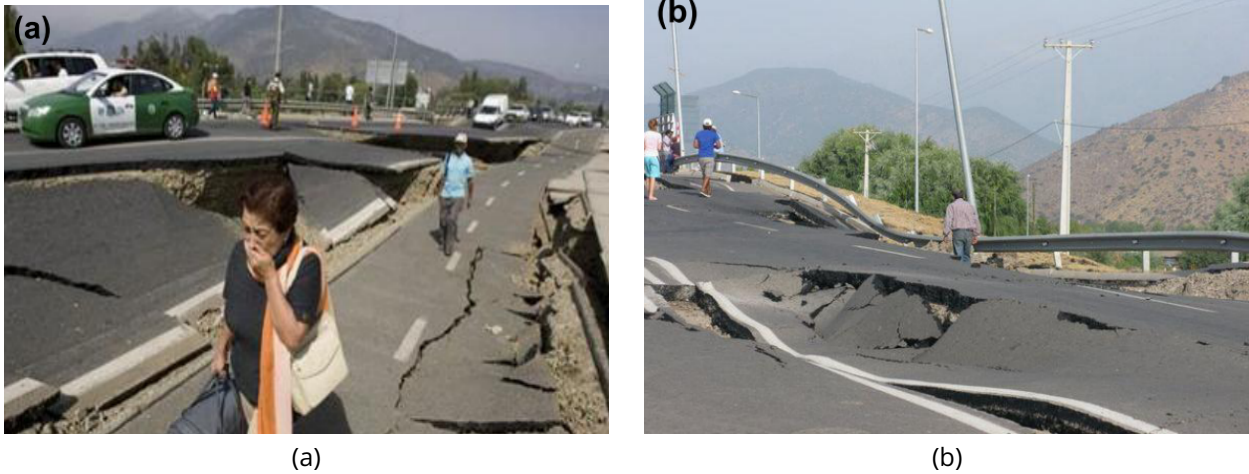
Figura 3.7.1: Daños producidos por licuación en Paso Superior Champa. Fuente: González (2015)
