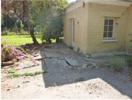
(a) Casa con fisuras y grietas en suelos.
