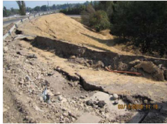
(b) Deslizamiento de terraplén.
