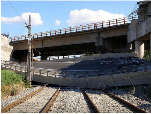
(a) Caída de tablero sobre línea férrea.
