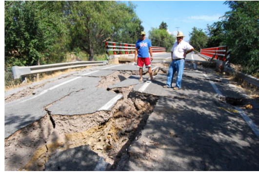
(b) Grietas profundas en el acceso de puente.
