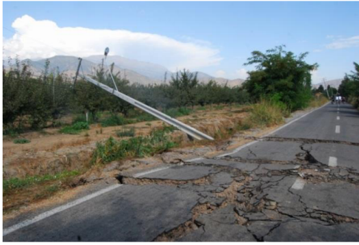
(a) Daños en el camino e inclinación de poste de tendido eléctrico.
