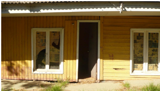
(a) Casa con asentamientos.
