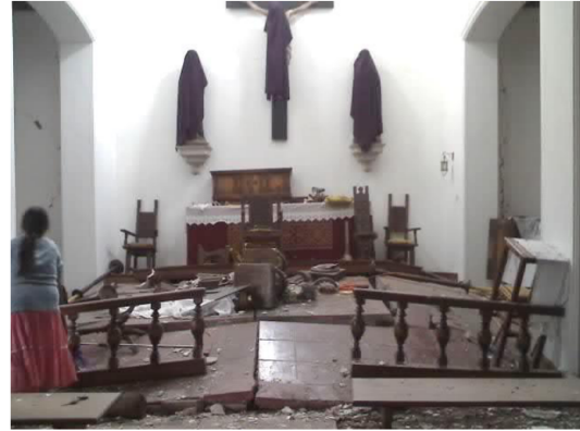
(b) Iglesia con asentamientos.
