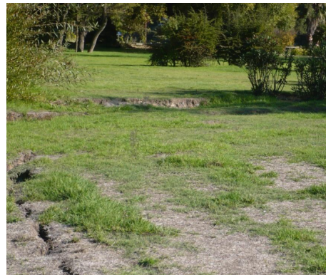
(b) Agrietamiento, fotografía con orientación hacia el suroeste.
