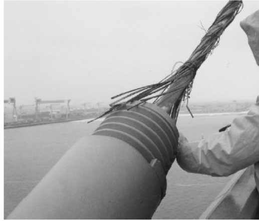
Figura 1.1: Ejemplo de falla de un cable en extremo inferior (Siegert y Brevet, 2005)
