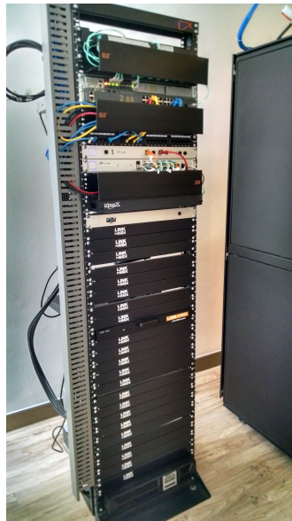
Figura 5.7: Servidor - Centro de Energía
