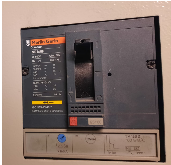
Figura 6.20: Interruptor general Edificio Centro de Energía.
