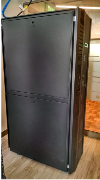
Figura 5.8: Servidor - Centro de Energía
