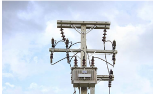
Figura 6.11: Red Eléctrica de Distribución.
