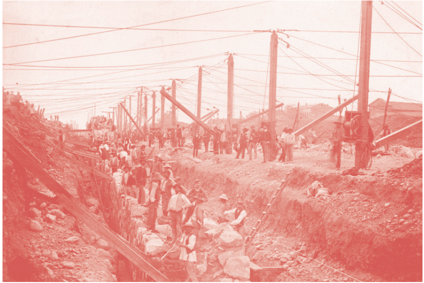
3. Obras de canalización del río Mapocho (1886-1891), Colección Fotográfica del Museo Histórico Nacional de Chile.
