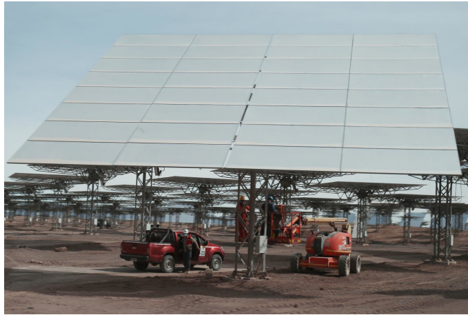
Figura 1.3: Heliostatos de Cerro Dominador.
