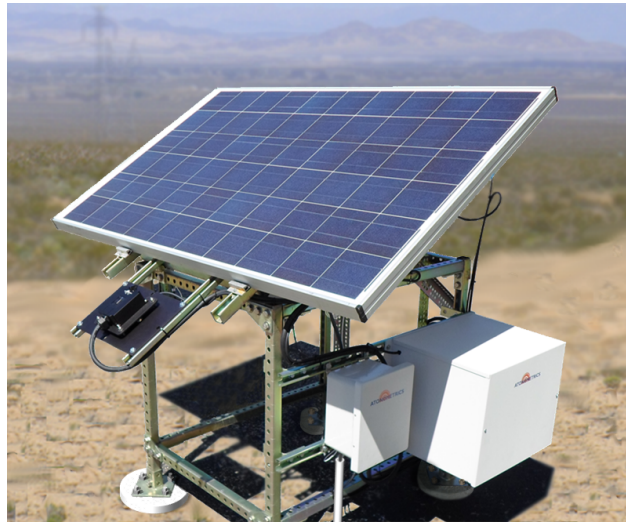
Figura 1.8: Dispositivo Soiling Station , que utiliza un panel solar y una celda de referencia para su comparación de rendimiento, además de un agente limpiador que debe ser rellenado cada cierto tiempo [26].
