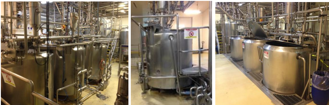
FIGURA 3: Tinajas de mezcla 1, 2 y 3 en área Pasteurización Planta Helados.
