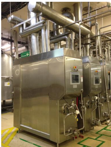
FIGURA 7: Freezers número 34, 28 y 12. Sector Impulsivo Planta Helados.
