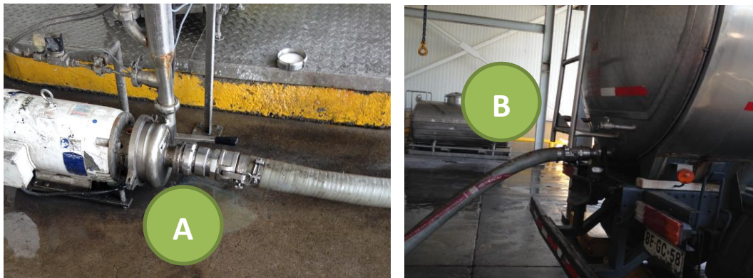
(A) Conexión Manguera-Bomba
