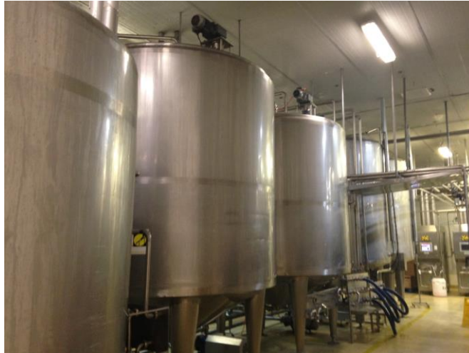
FIGURA 6: Estanques de Maduración número 68, 72, 74 y 76. Sector Impulsivo Planta Helados.
