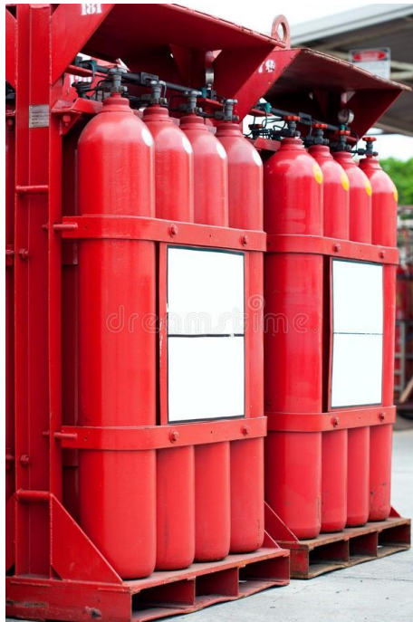
Figura 2.7: Rack de estanques de CGH 2
