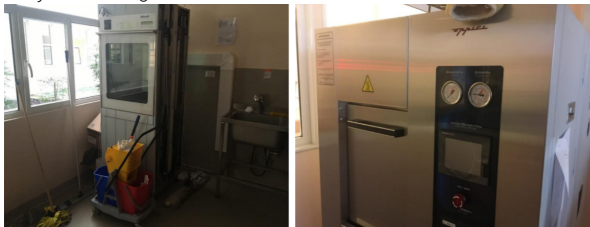
Figura 4. Sala de lavado y descontaminación Hospital de Rancagua. Figura 5. Autoclave Hospital de Rancagua. Fuente: Margarita Sepúlveda.
