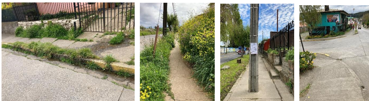
Figura 80. Imagen uno, vereda en mal estado; imagen dos, maleza en vereda; imagen tres, poste mal emplazado; imagen cuatro, vereda con pendiente pronunciada. Fuente: registro propio.
