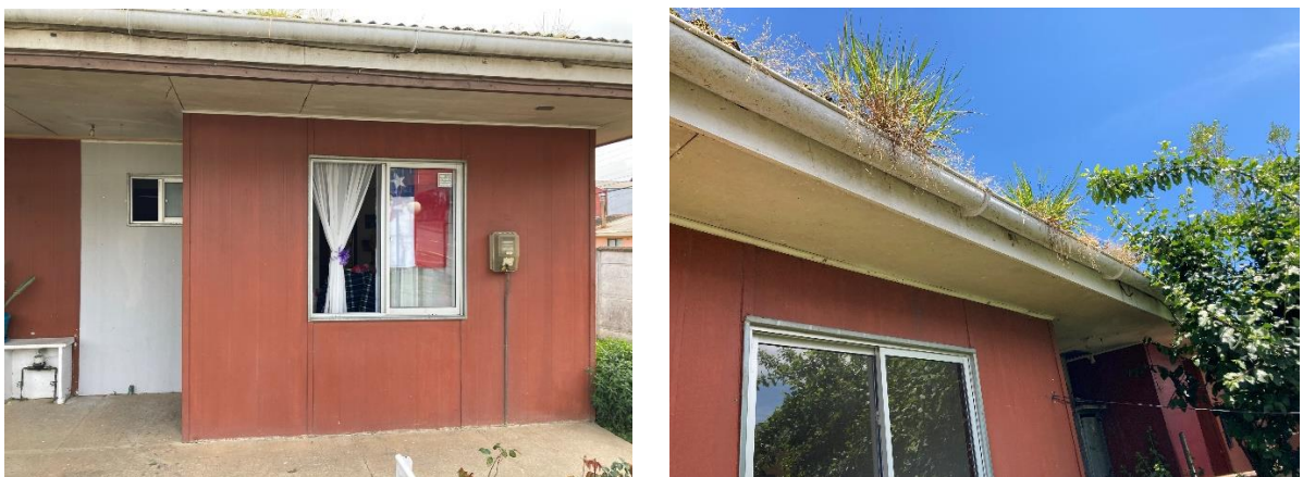
Figura 25. Imagen 1. Revestimiento de las viviendas; imagen 2, canal de aguas lluvias sin mantención. Fuente: registro propio.
