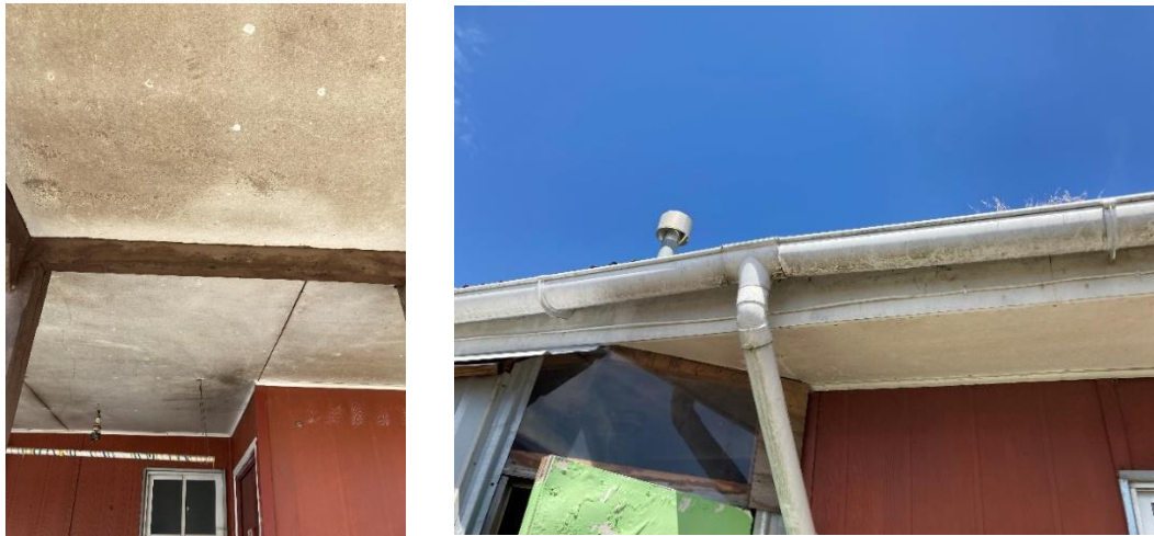
Figura 26. Imagen 1, humedad en revestimiento cielo; imagen 2, canaletas rotas. Fuente: registro propio.
