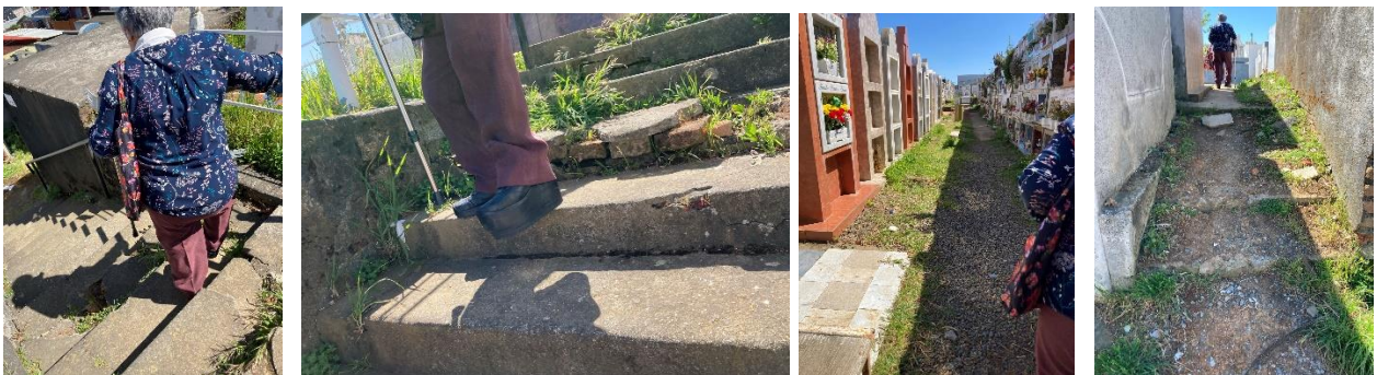
Figura 77. Imagen uno, Sra. Marcela bajando escaleras de Cementerio; imagen dos, peldaños en mal estado de escalera Cementerio; imagen cuatro, ausencia de pavimento en pasaje; imagen cuatro, escaleras de Cementerio para tomar calle que llega a la salida de éste.
