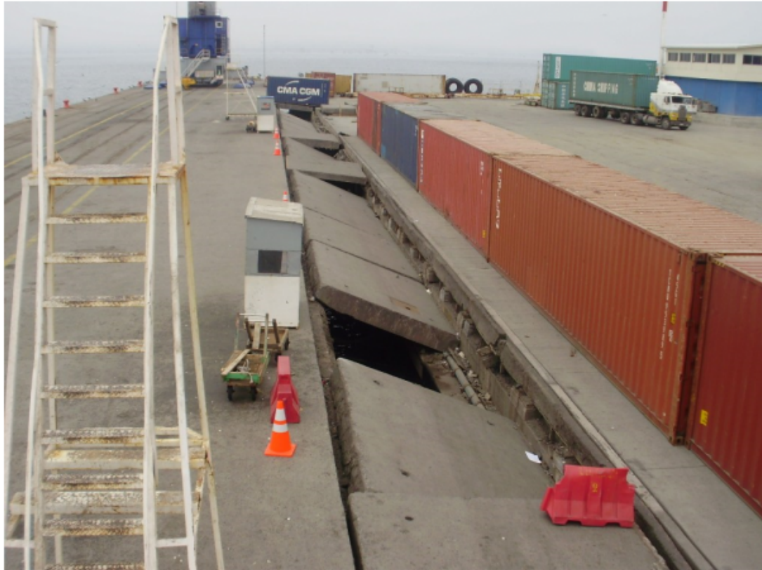
Figura 3.6: Daños sufridos en losa de traspaso sitio 1 (Portal Portuario, 2020).
