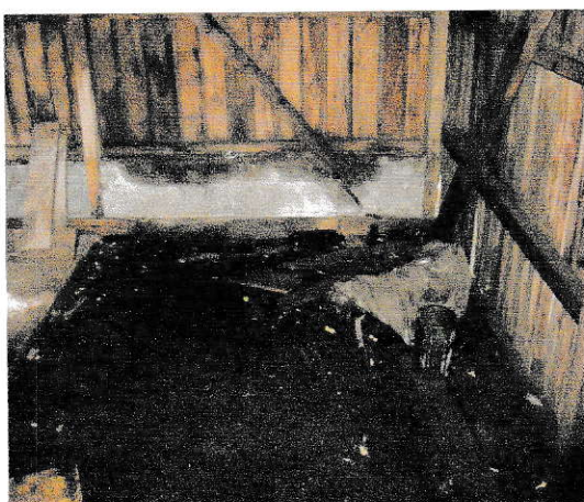
e) Bodega con suelos contaminados
