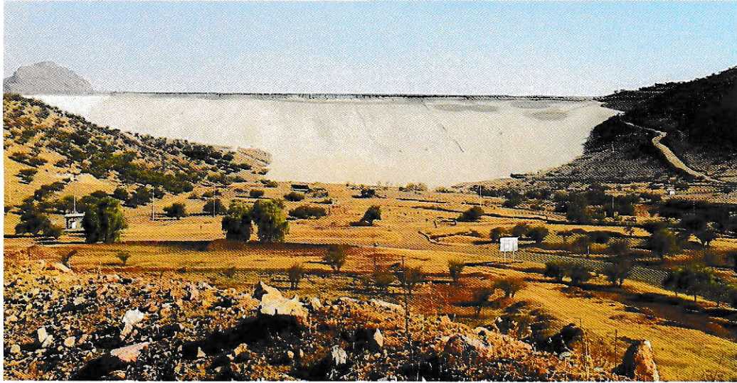
Figura 83. Imagen de riego no homogéneo en coronamiento de sector 2-B y sector 3.
