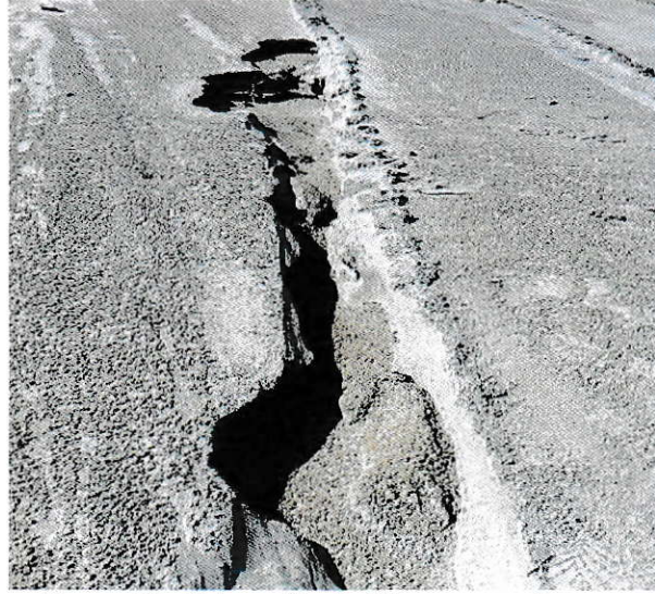
Figura 60. Fotografía de Cárcava en el muro.
