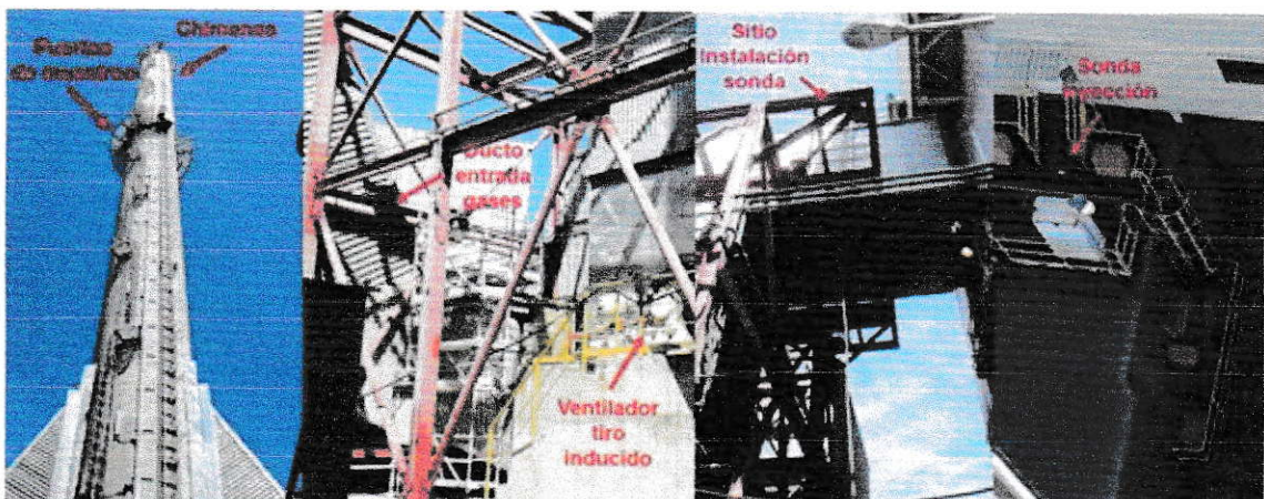
Figura 18. Ubicación punto de inyección de polvo y puertos de muestreo de la Unidad de Generación Eléctrica 4 del Complejo Ventanas.
