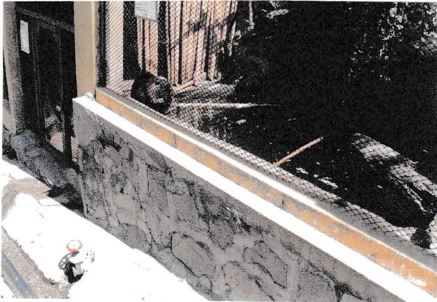
Fotografía N° 2 “Válvulas desde piscinas hacia canaletas”
