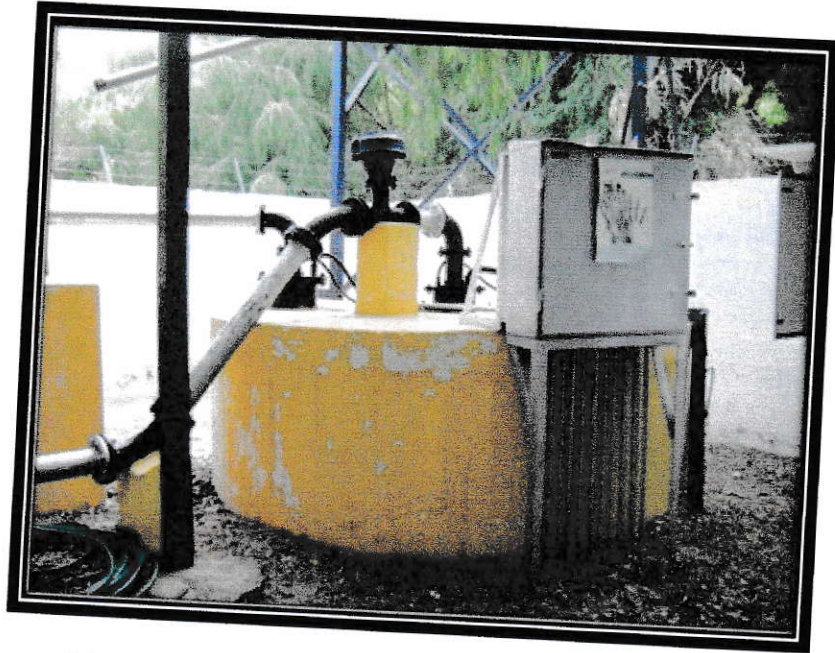
Figura 4: Extracción de agua por APR Pisco Elqui
