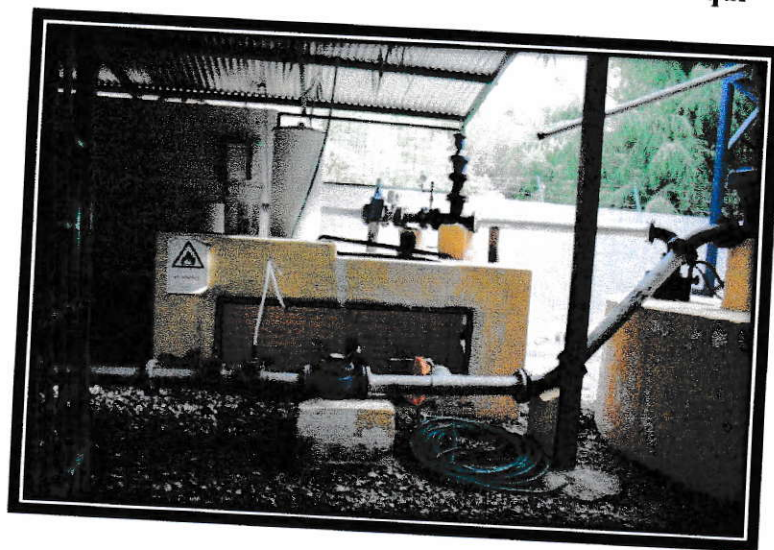
Figura 5: Cloración de las aguas APR Pisco Elqui
