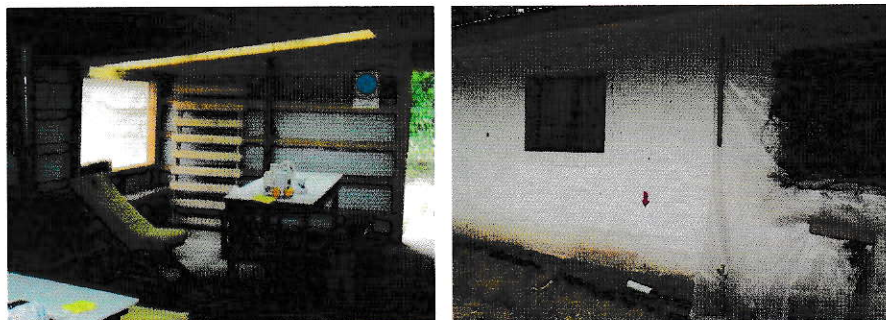
Figura 13: Infraestructura comedor - Conservación de la estructura y control de roedores.
