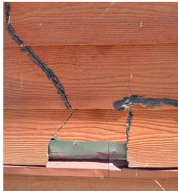
Fig. 89 Mal estado del revestimiento exterior Fotografía tomada por el autor
