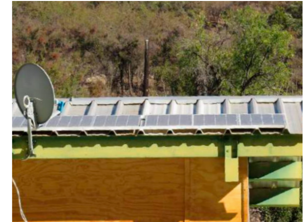
Fig. 97 Paneles fotovoltaicos Fuente: Informe de Revalidación de la Certificación Ambiental, Escuela Chacayes
