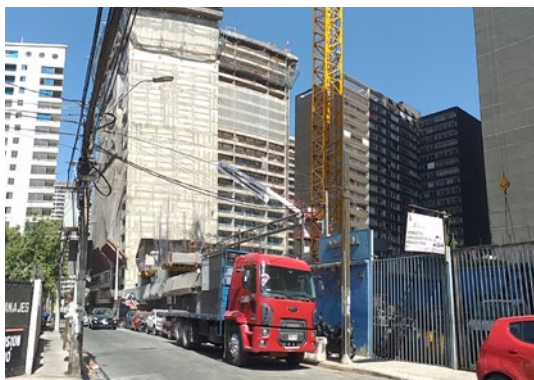
Figura 4: Saturación de las vías por el tránsito de vehículos de carga hacia las faenas de construcción, ya que se deben realizar cargamentos constantes de materiales y retiros de desechos durante el proceso. Fuente: Elaboración Propia, 2020.
