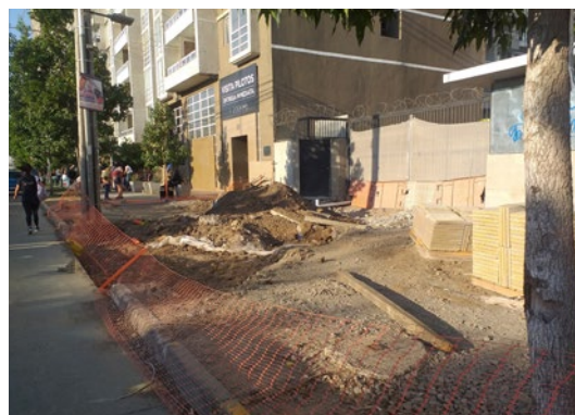
Figura 5: El modo de instalación de las faenas de construcción provoca un sentimiento de inseguridad, al momento de transitar por las zonas que se encuentran en proceso de construcción. Fuente: Elaboración Propia, 2020.
