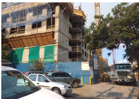
Figura 8: Congestión vehicular, debido a la llegada de vehículos de carga, y conflictos de uso del espacio público, siendo utilizado como área de estacionamiento por parte de los trabajadores de la faena en la calle Toro Mazotte, Estación Central. Fuente: Elaboración Propia, 2020.
