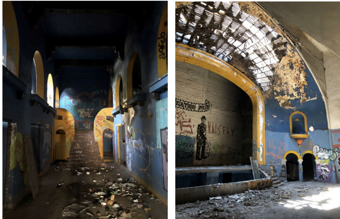
Daños estructurales al interior del edificio. Quemadura de la madera y desprendimiento de quinchita. (2016). Fuente: Romero, M.
