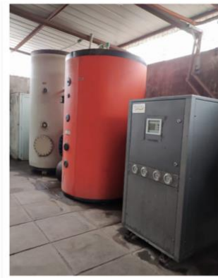
Figura 16: Bomba de Calor, Unifrutti, Chile. Fuente [9]: Unifrutti, 2012.
