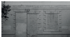
Estado de deterioro y modificación para privatizar el inmueble. Fuente: Elaboración propia.
