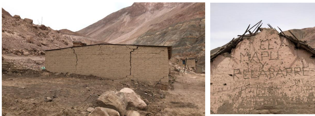
Figura 3.2-17: Viviendas Livilcar con daños antropogénicos.
