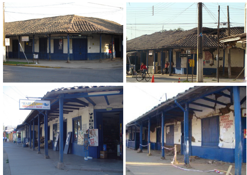
Figura N°38: Fotografías antes y después del terremoto, vivienda Fuenzalida. Fuente: Ilustre Municipalidad de Chépica.
