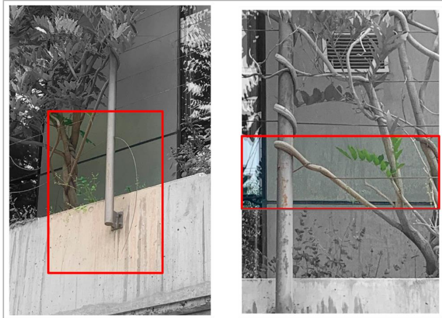
Figura 6: Falla del cable horizontal producto de la planta trepadora Wisteria Sinensis.
