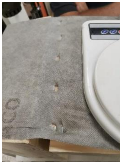
Figura 43: Desgarro en membrana Ultrafeltro. Nota. Elaboración propia, 2022
