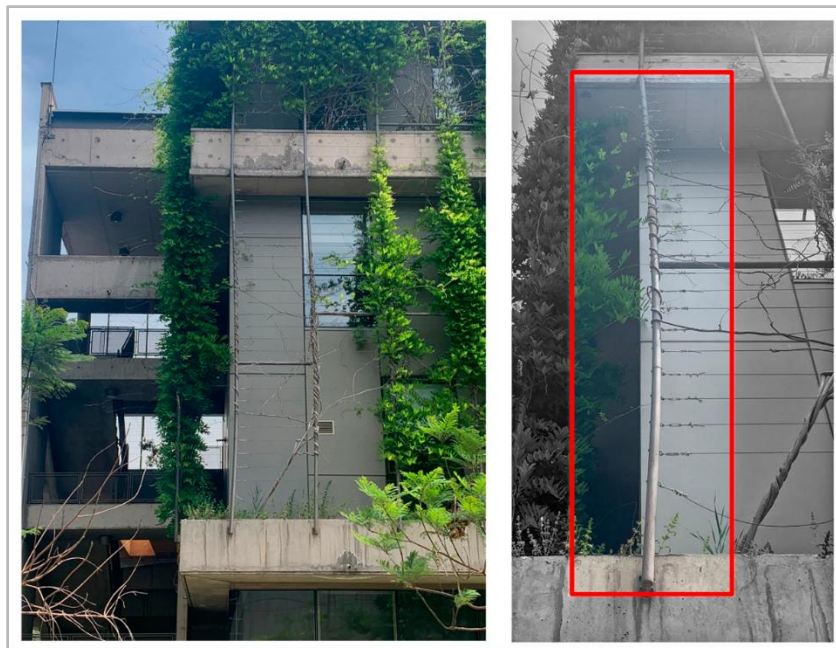
Figura 7: Flexión de pilar producto de la carga de la planta trepadora Wisteria Sinensis.
