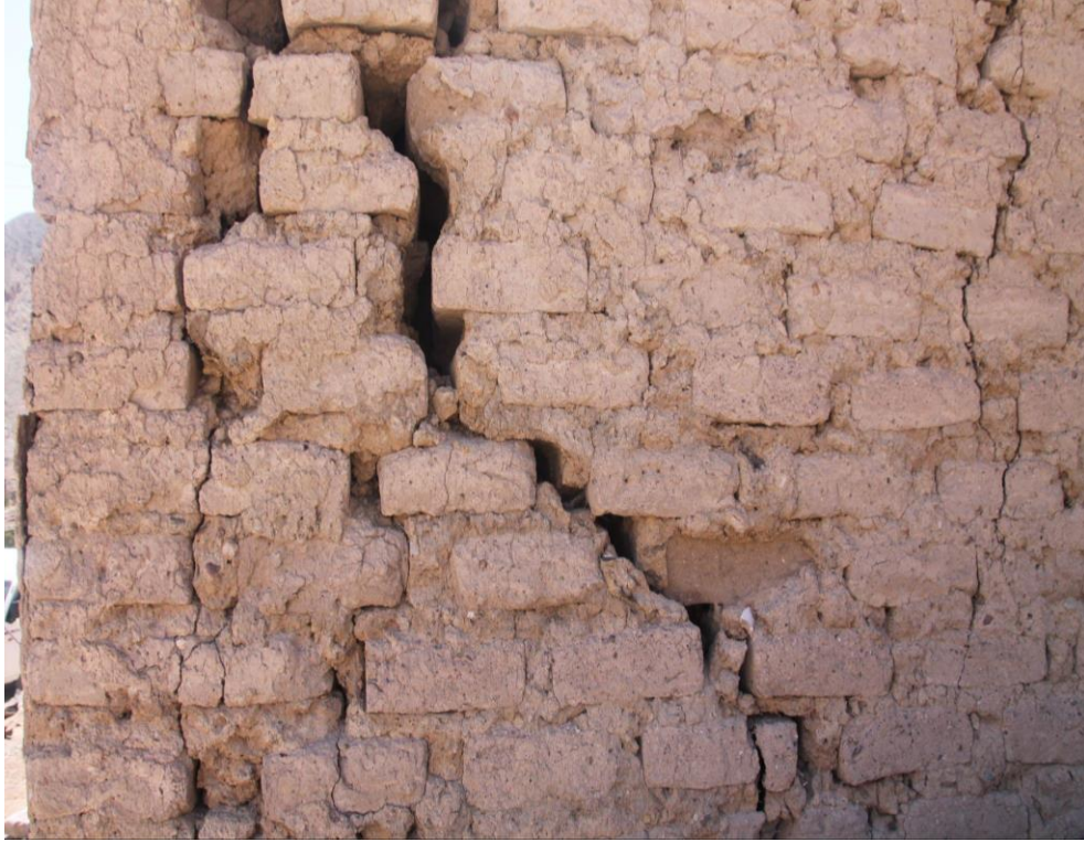
Figura 8: Elaboración propia. Sept, 2022. Falla estructural en un muro de adobe de Mocha después del sismo de 2005. Fotografía.
