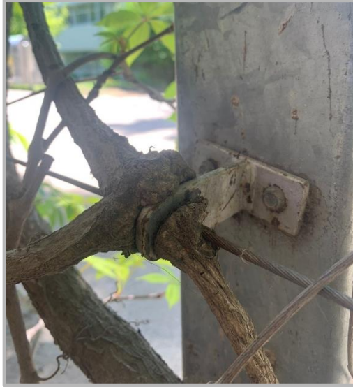
Figura 10: Crecimiento de planta entre la unión de la estructura.
