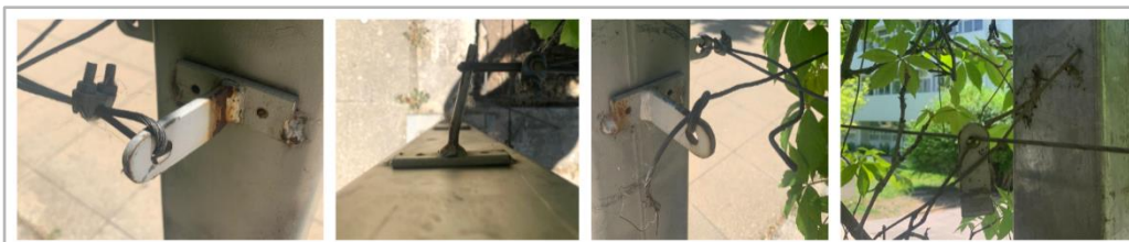
Figura 9: Falla unión estructural, fachada vegetal Universidad de Talca.
