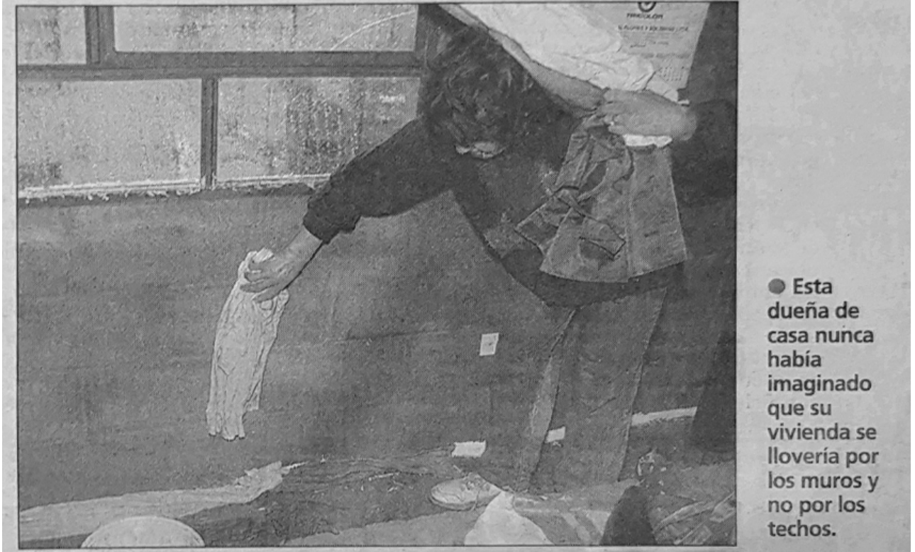
Figura 19: Mujer mostrando la humedad filtrada en los blocks de las murallas [Fotografía]. Roberto Guerrero, 1997.
