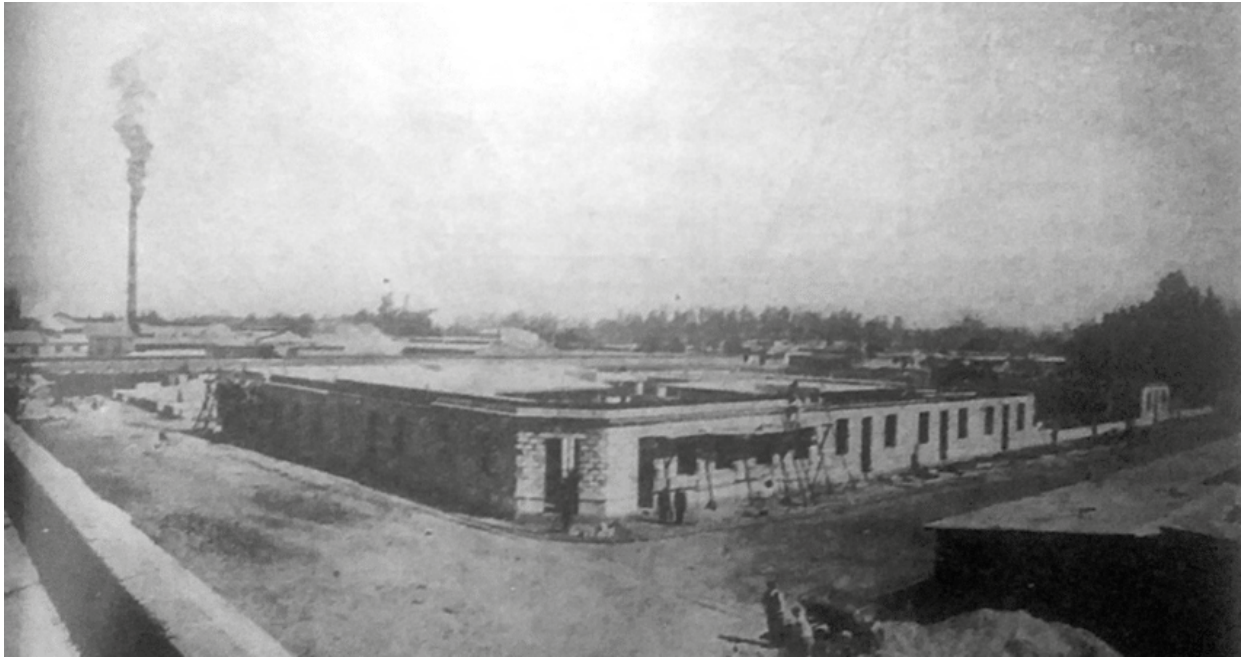
Figura 1: Construcción de las casas de la población obrera “Huemul”. Al fondo se observa la chimenea de la refinería de azúcar [Fotografía] Extraído del artículo de González e Ibarra, 2020, p 85.
