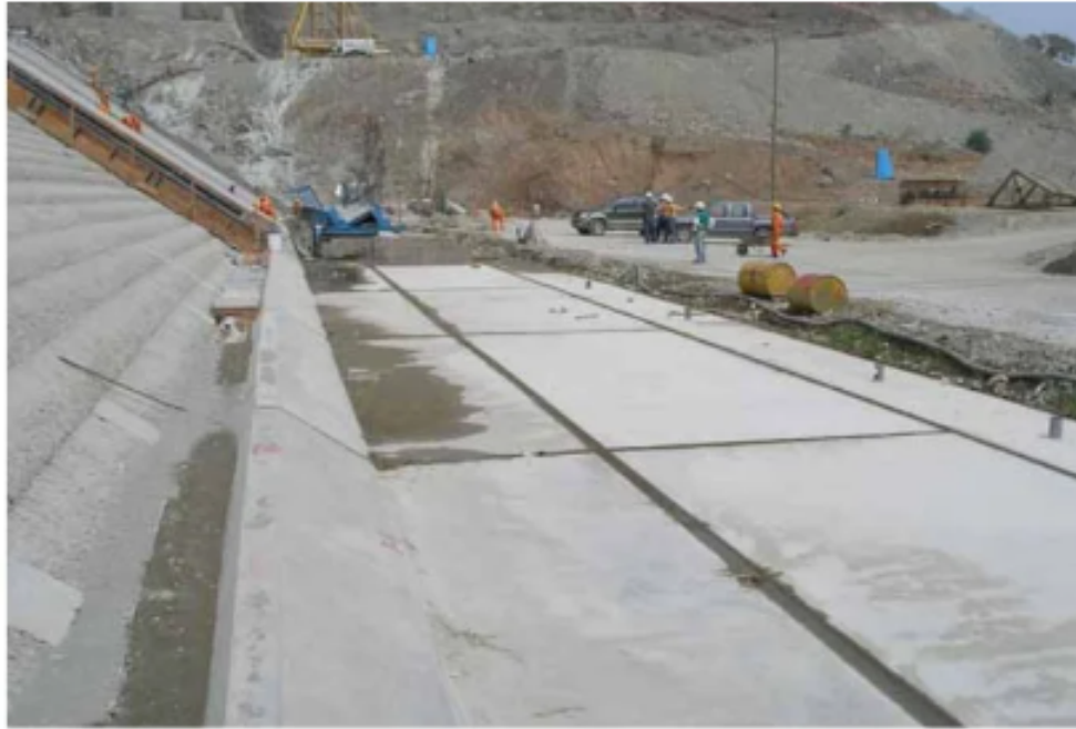
Figura 4.13: Junta Plinto-Muro en lecho del río, Presa Limón/Olmos, Perú; Fuente Ing. Presas de Escollera.
