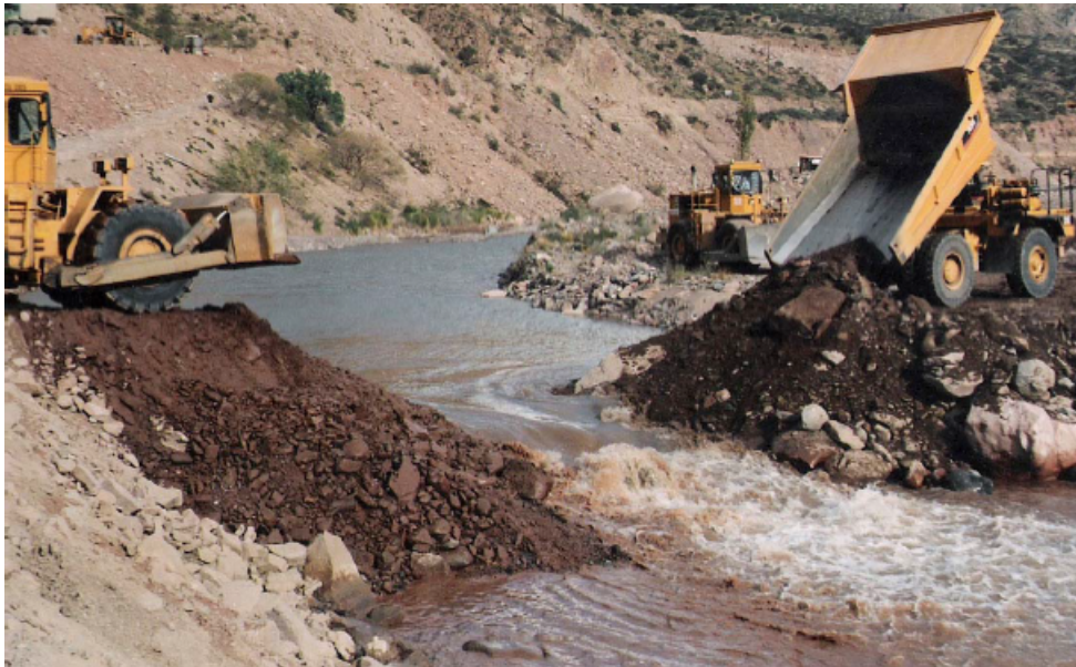
Figura 4.7: Acumulación de rellenos en laderas; Fuente Ing. Presas de Escollera.
