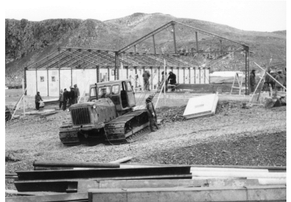
Construcción Base Frei. Fuente: Presentaciones Fuerza Aérea Chilena facilitadas por el Comandante (BA) Fernando Machuca
