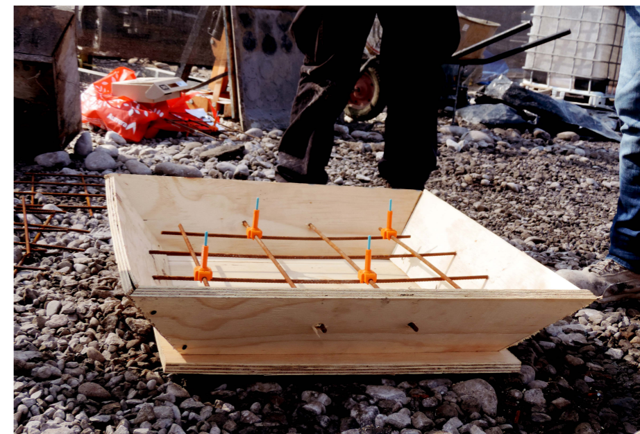
Figura 106: Cajón con marcadores instalados. Elaboración propia.
