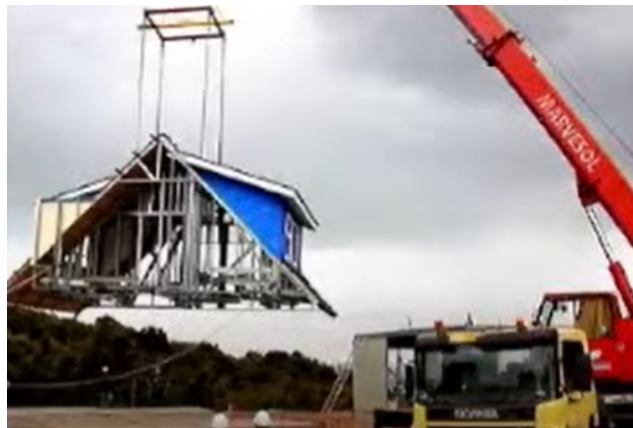
Figura 3.12: Cercha prefabricada utilizada en una obra AXIS. Fuente: Exposición Encuentro Técnico "Gestión de residuos en obra".
