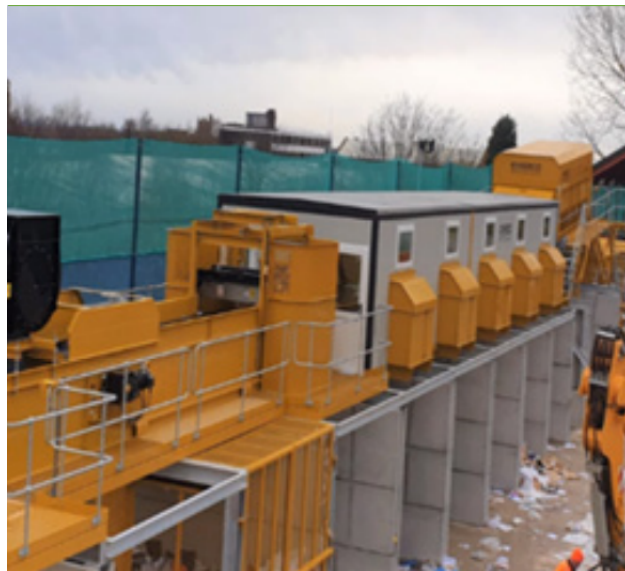
Figura 3.30: Planta de valorización de RCD. Fuente: ( greenrec.cl , 2022)
