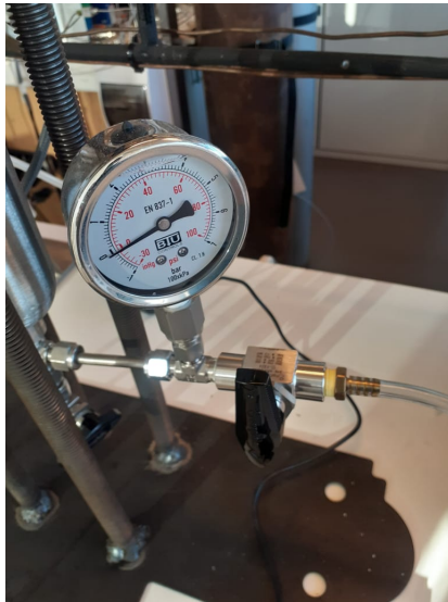
Figura 2.8: Vacuómetro instalado en el equipo.
