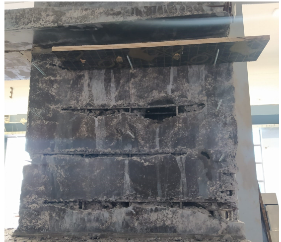
(b) Daño Registrado en la zona Central del Muro Grande (MR1).
