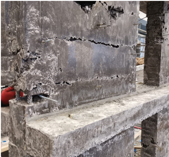
(a) Daño Registrado en el Muro Grande (MR1)
