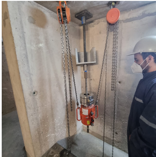
(a) Daños Sufridos por el Pedestal al Momento del Postensado (1)
