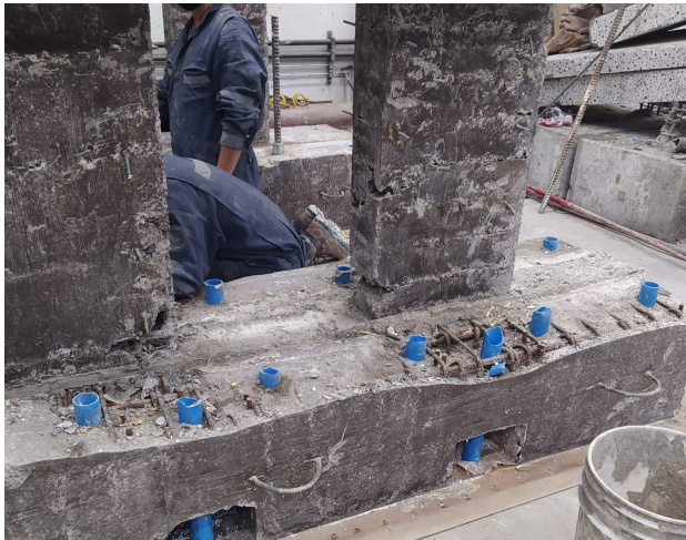
(a) Daño Registrado en el Pedestal
