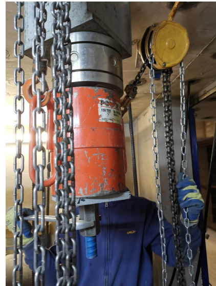
(b) Daños Sufridos por el Pedestal al Momento del Postensado (2)
