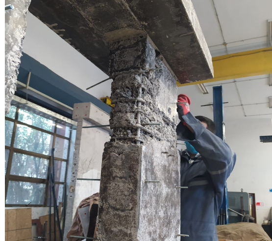
(b) Daño Registrado en el Muro Grande (MR2)
