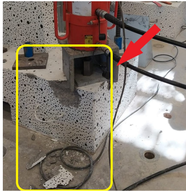
(b) Daños Sufridos por el Pedestal al Momento del Postensado (2)
