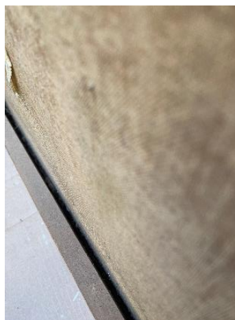
Ilustración 125: Detalle del chafan que tiene el bastidor.
