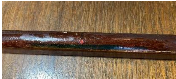
Ilustración 22: Mancha encontrada en la parte inferior del marco.
