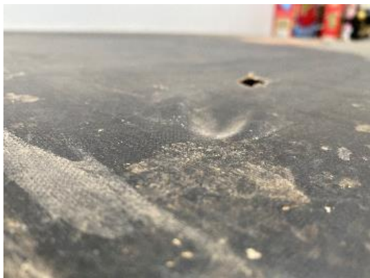
Ilustración 74: Luz rasante, enseña la profundidad de la pérdida del plano por golpe.
