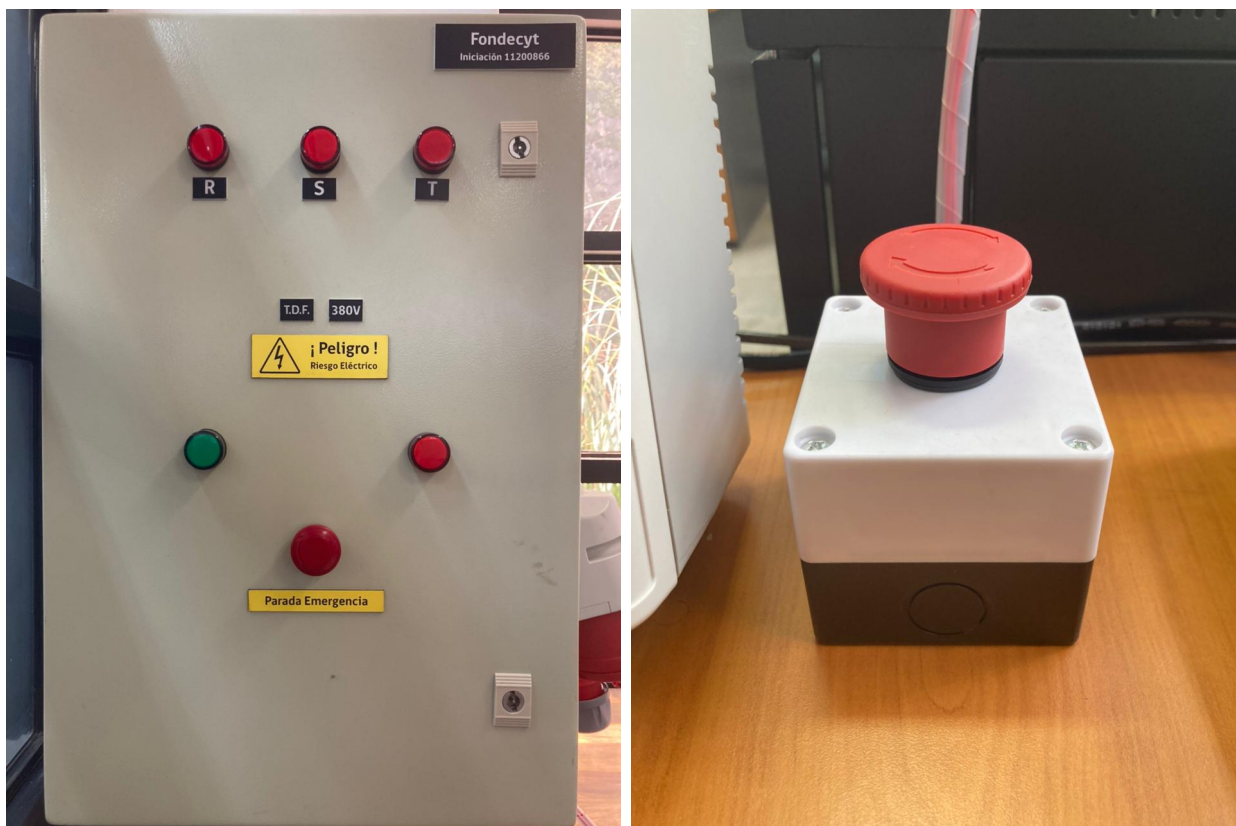
(a) Botón de emergencia en tablero.
