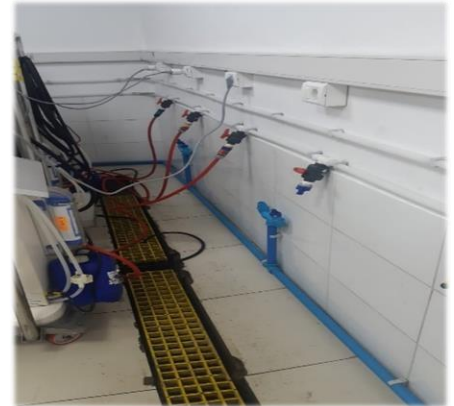
Ilustración 8: Conexiones en Sala de Lavado
