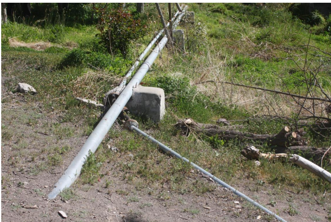
Ilustración 127: Infraestructura APR Cogotí: Tubería impulsión en mal estado.
