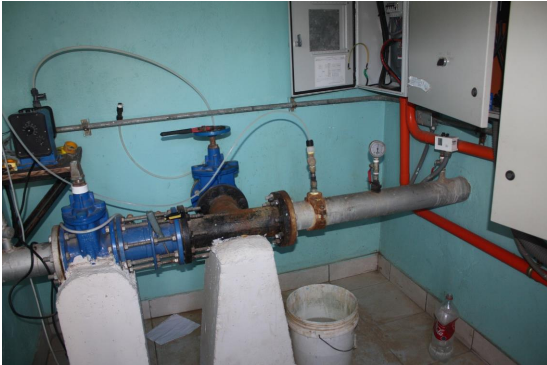
Ilustración 105: Instalaciones APR Rapel: Cloración, presostato, manómetro, válvulas.
