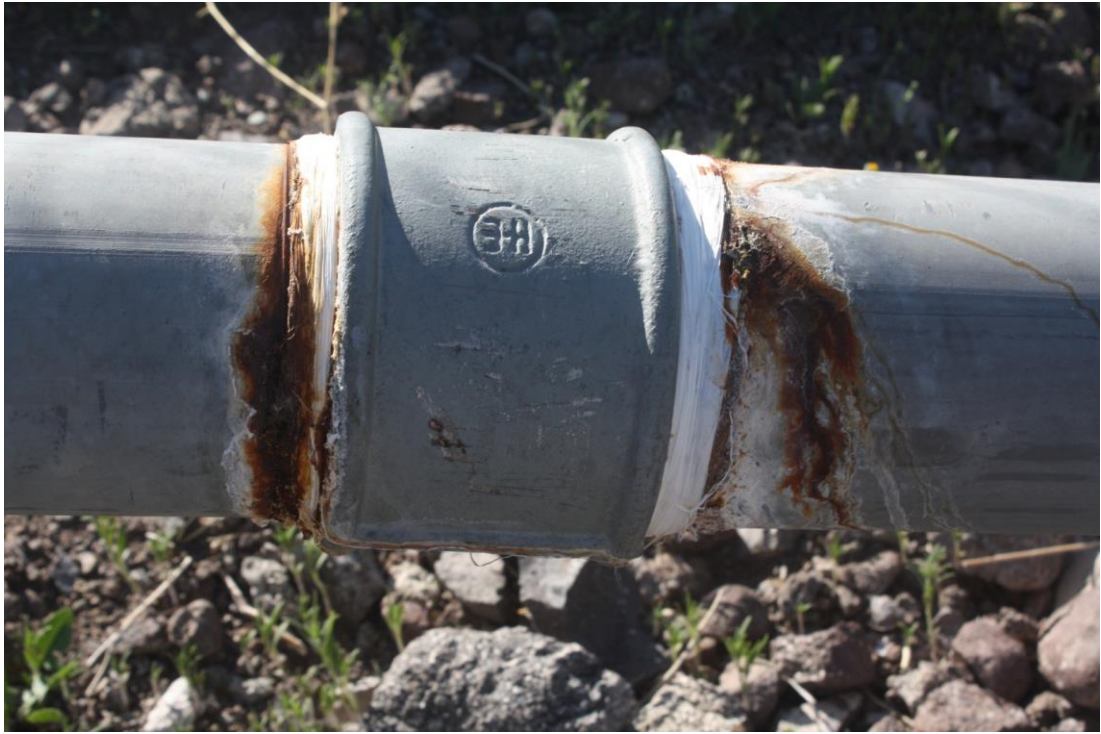
Ilustración 124: Infraestructura APR Cogotí: Tubería impulsión en mal estado.
