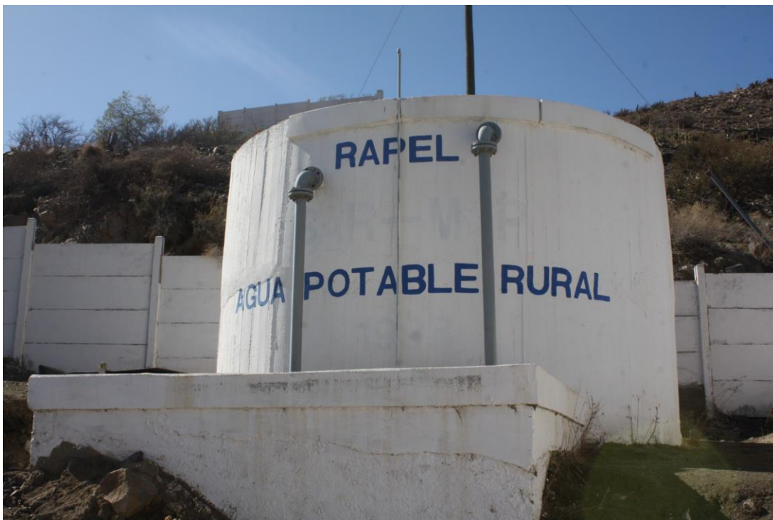
Ilustración 110: Instalaciones APR Rapel: Estanque Rapel 50 [m3].
