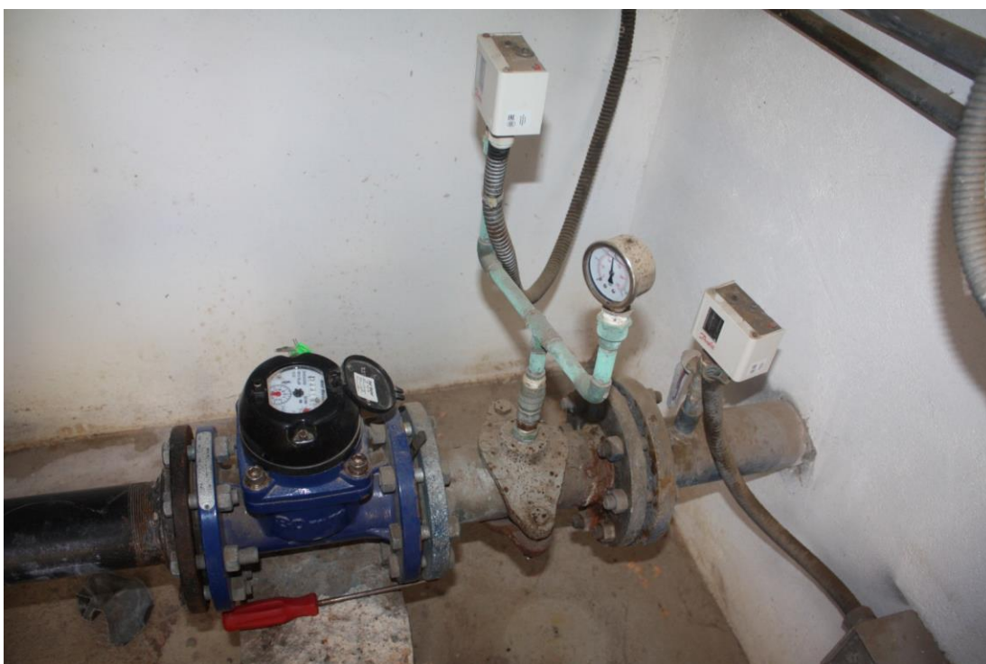
Ilustración 117: Infraestructura APR Cogotí: caudalímetro, manómetro, presostato.
