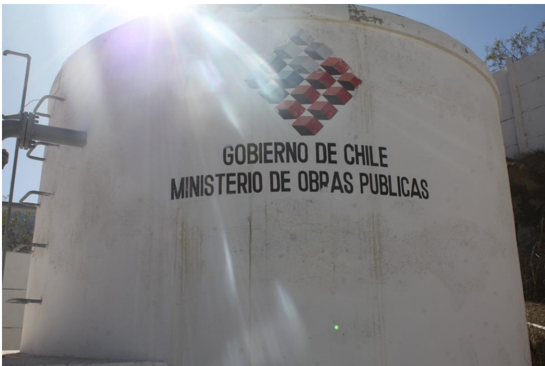
Ilustración 111: Instalaciones APR Rapel: Estanques Rapel 50 [m3].
