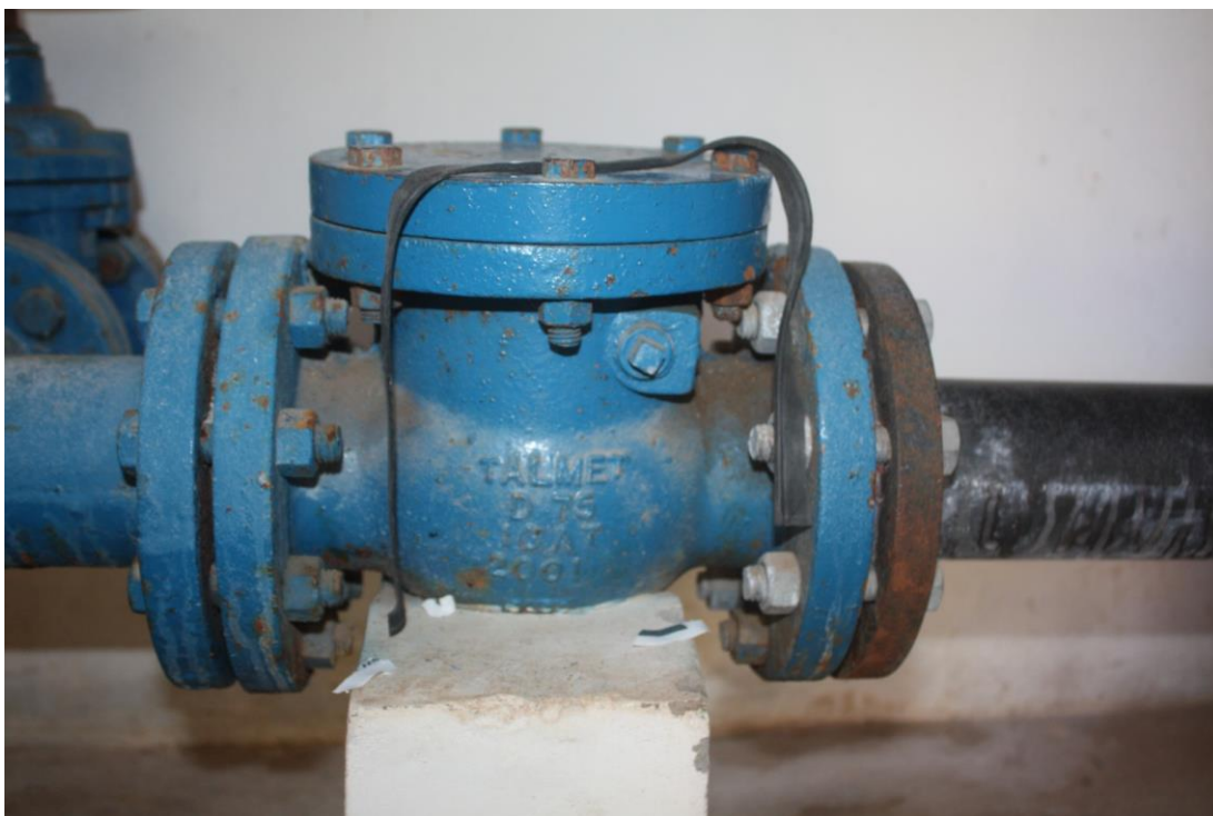
Ilustración 119: Infraestructura APR Cogotí: válvula de retención.
