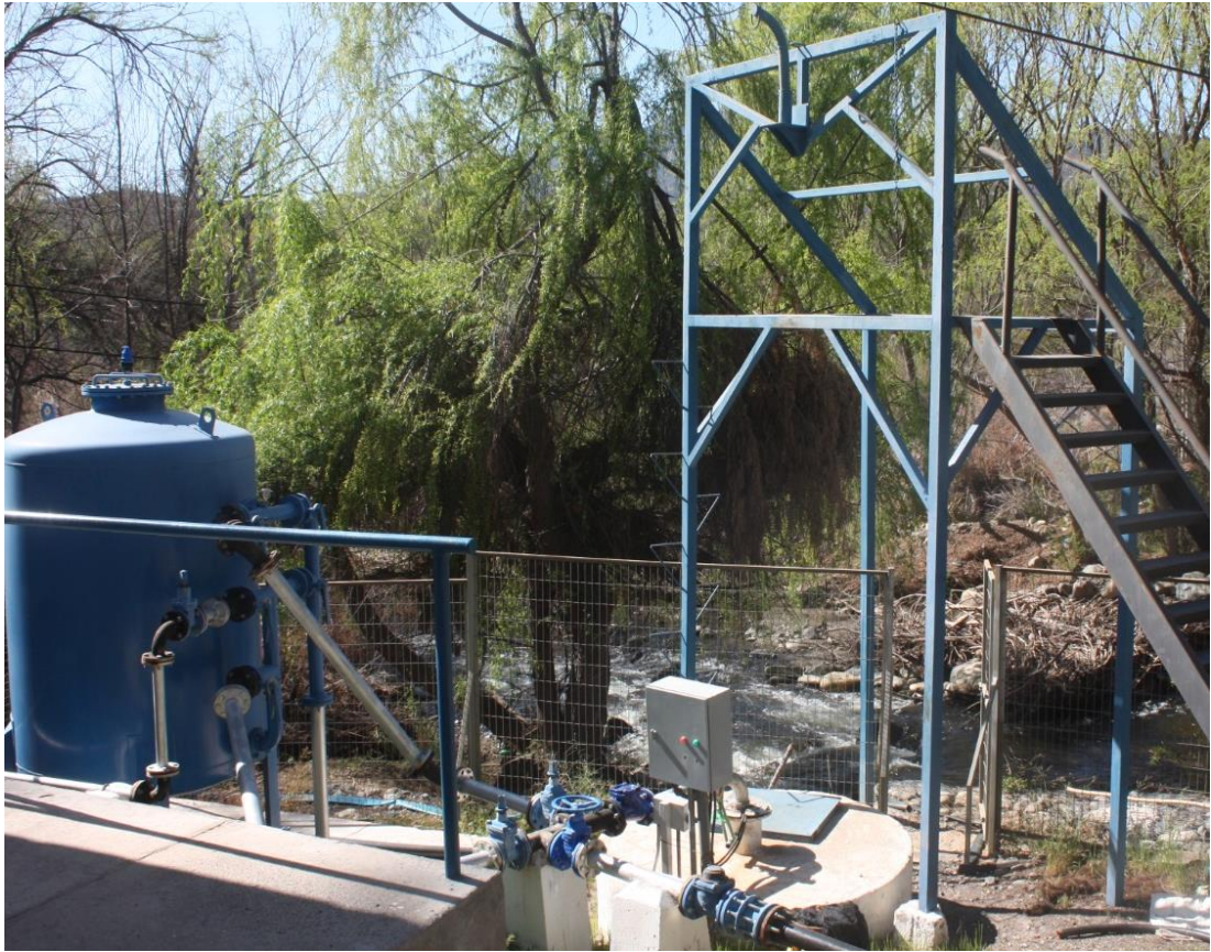
Ilustración 120: Infraestructura APR Cogotí: pozo, filtro, válvulas.
