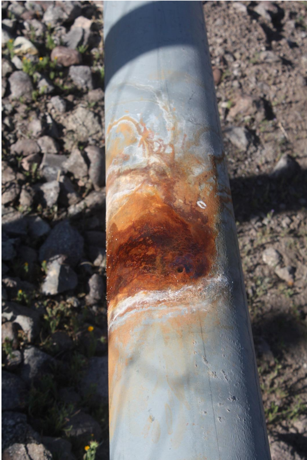
Ilustración 125: Infraestructura APR Cogotí: Tubería impulsión en mal estado.
