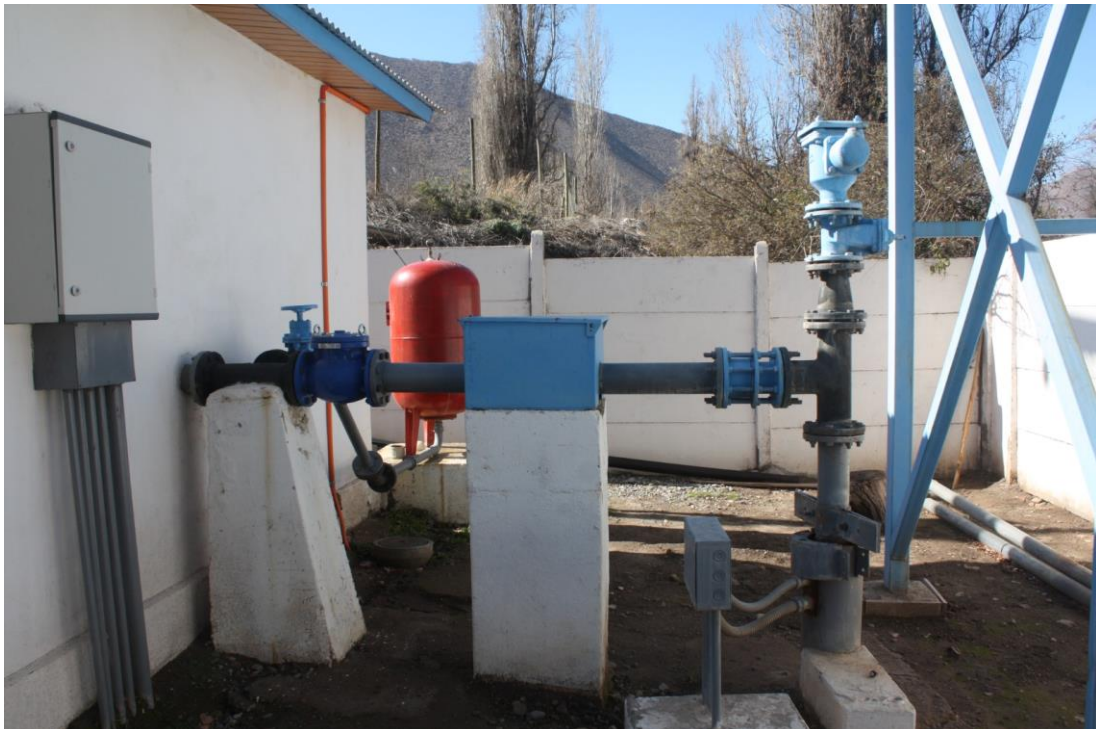
Ilustración 106: Instalaciones APR Rapel: válvula de retención, caudalímetro y pozo con válvula de aire.
