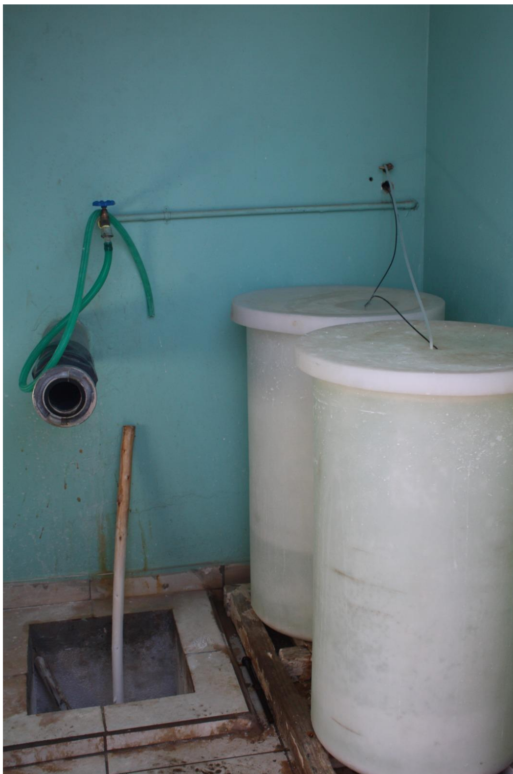
Ilustración 108: Instalaciones APR Rapel: sistema de cloración.
