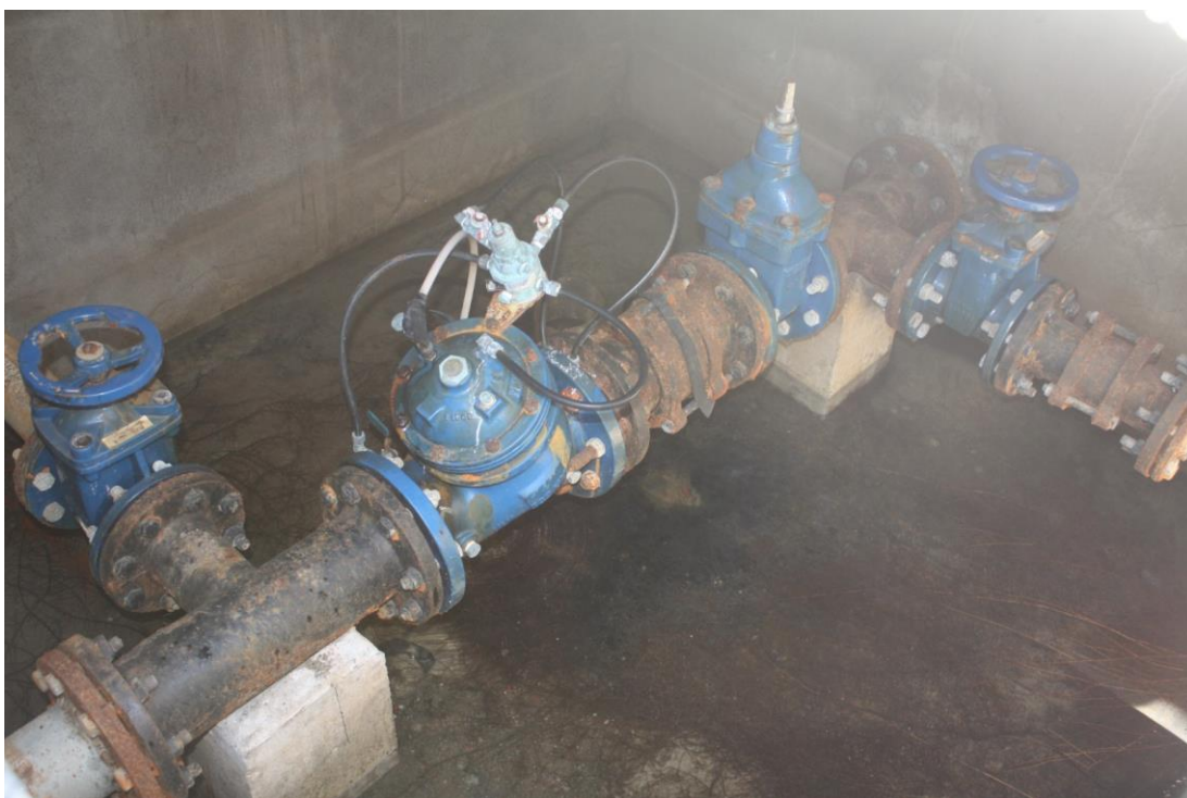
Ilustración 112: Instalaciones APR Rapel: válvulas cámara anterior a los estanques.
