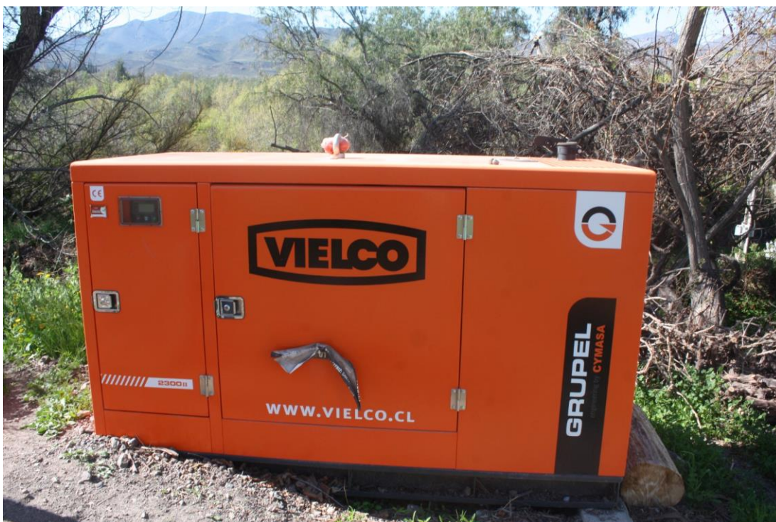
Ilustración 118: Infraestructura APR Cogotí: Generador no conectado.
