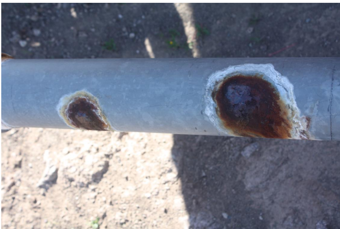
Ilustración 128: Infraestructura APR Cogotí: Tubería impulsión en mal estado.
