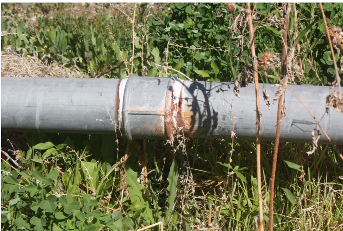
Ilustración 123: Infraestructura APR Cogotí: Tubería impulsión en mal estado.
