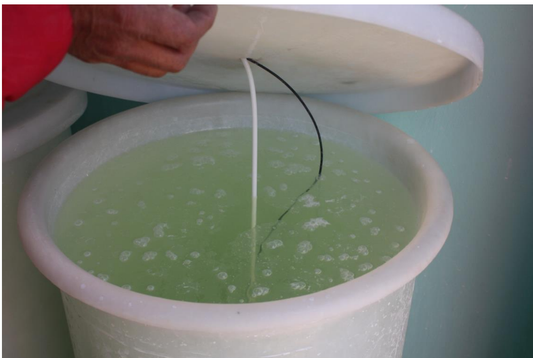
Ilustración 107: Instalaciones APR Rapel: sistema de cloración.
