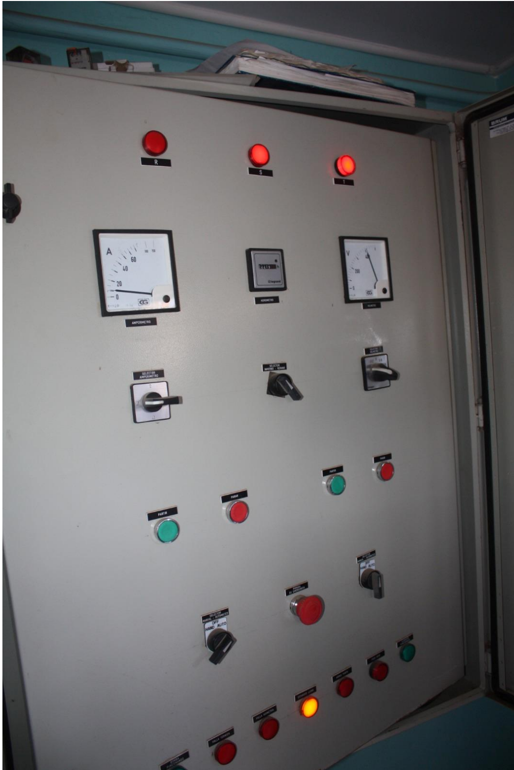
Ilustración 109: Instalaciones APR Rapel: tablero eléctrico.
