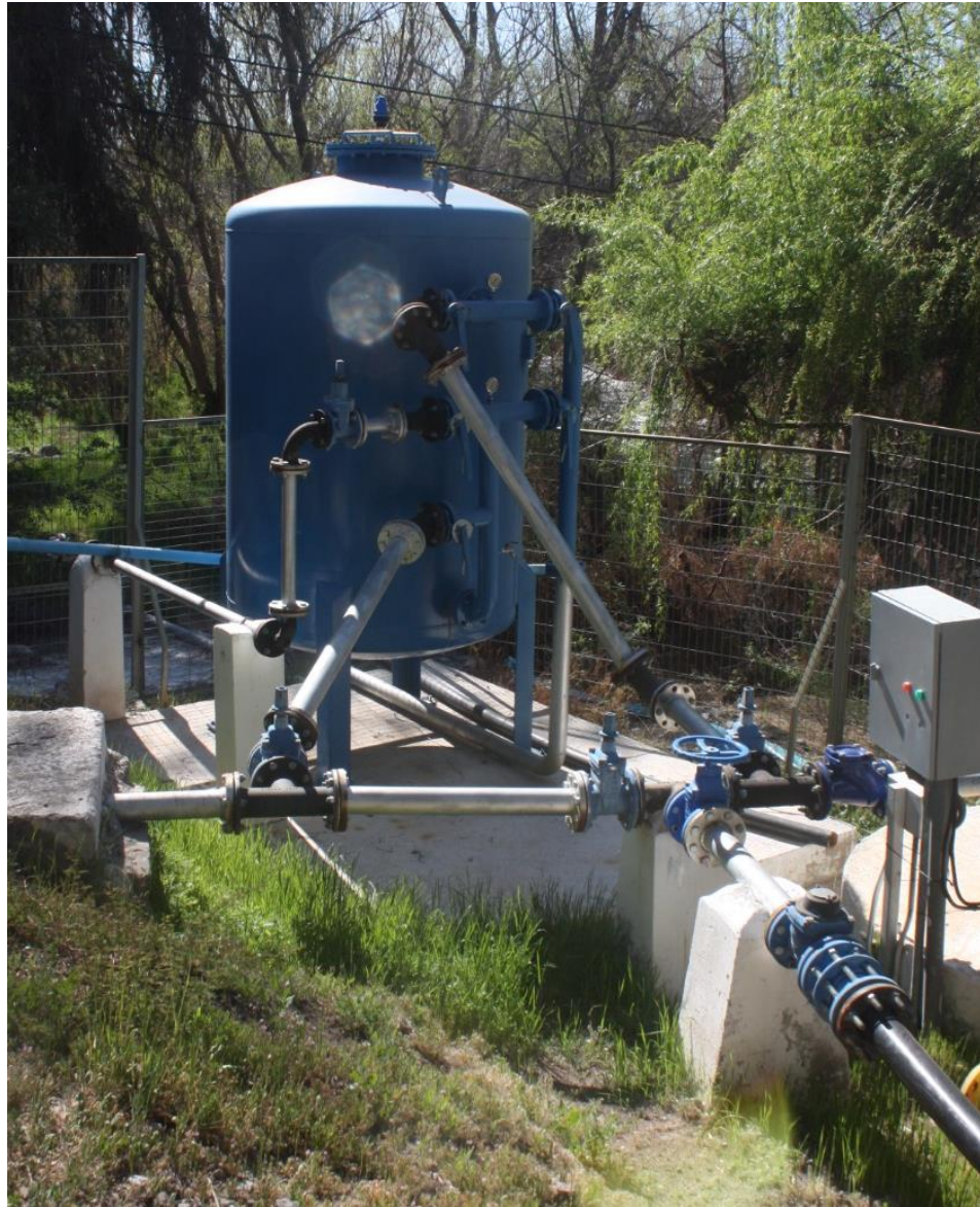
Ilustración 121: Infraestructura APR Cogotí: filtro.
