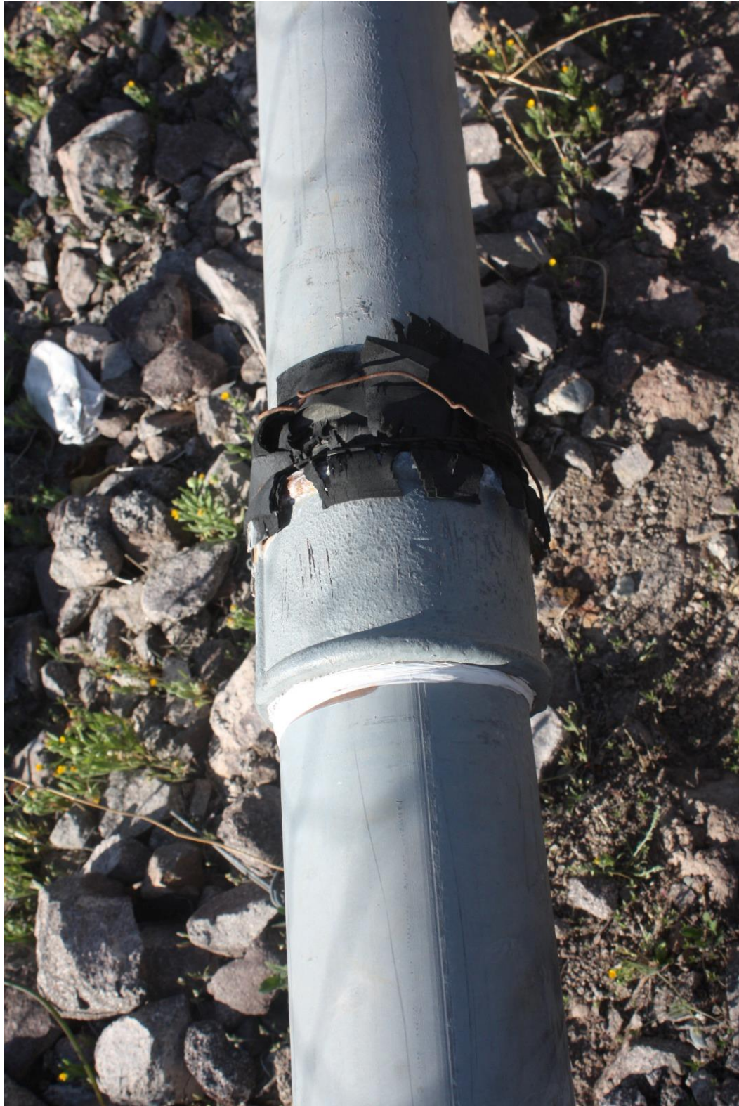
Ilustración 126: Infraestructura APR Cogotí: Tubería impulsión en mal estado.
