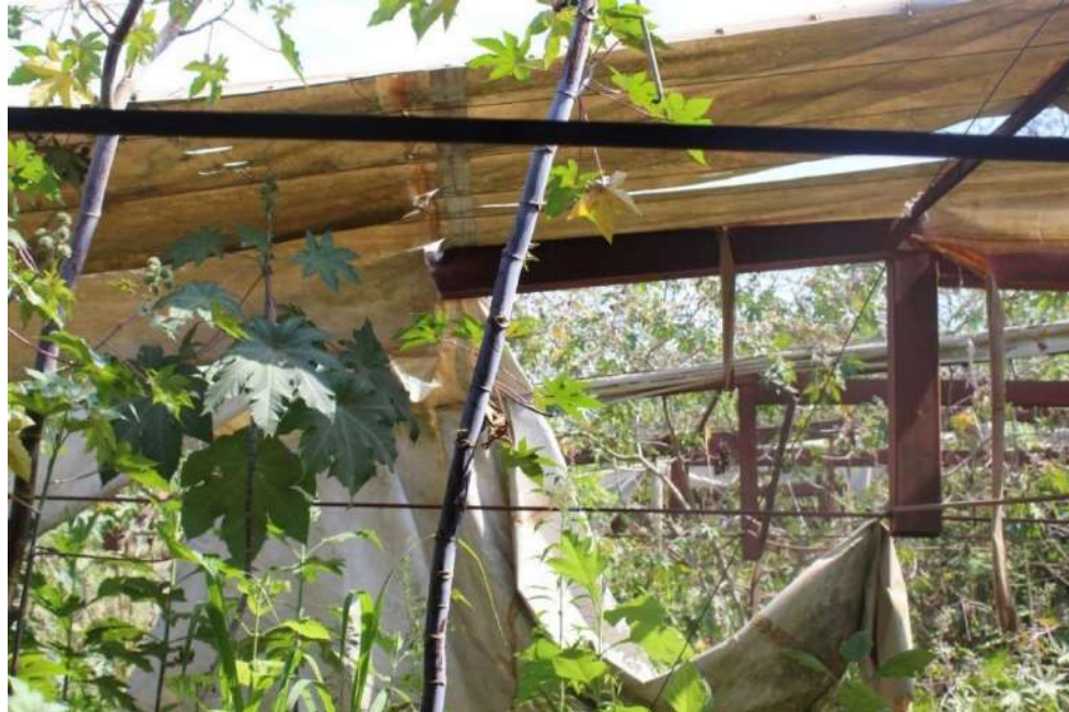
Figura 63 Techo que cubre parcialmente las inhumaciones y que se encuentra en mal estado (2021).
