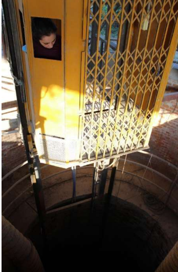
Figura 67 El ascensor y mecanismo de traslado de personas y materiales al interior del pozo.
