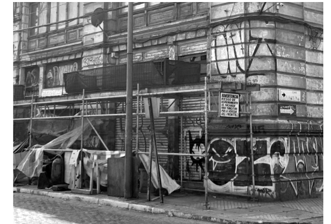
Fig 20. Fachada en deterioro. Elaboración propia.
