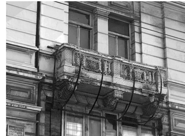
Fig 19. Balcones en deterioro. Elaboración propia.
