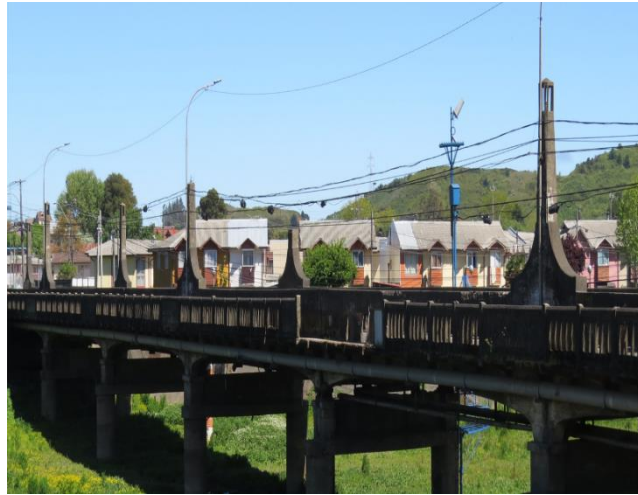
Figura 17. Fotografía del lado sur del Puente Andalién, que demuestra el estado de vulnerabilidad y deterioro en que actualmente se encuentra este viaducto. (Concepción, Chile). Autor. Marcelo Bravo, 2021.
