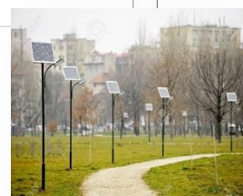
ALUMBRADO CON PANELES ECOLÓGICOS
